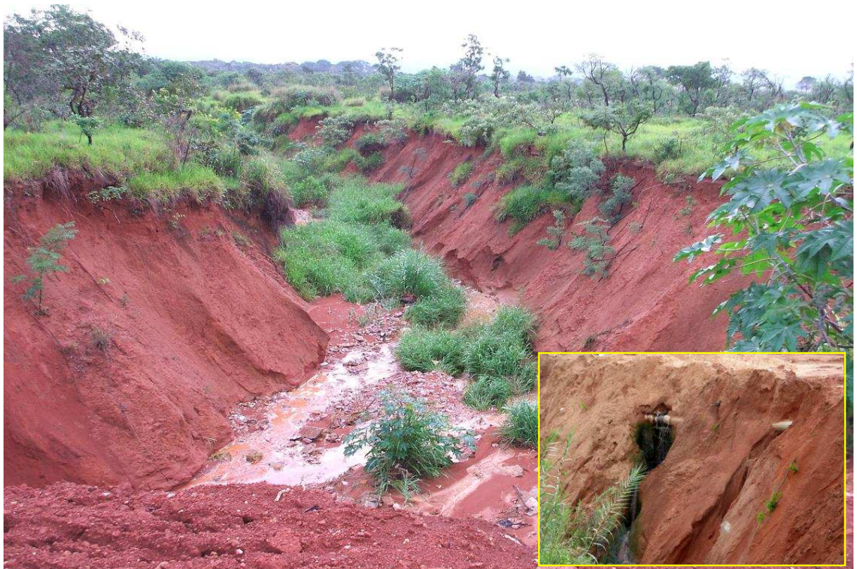
Figura 8.4 – Erosão oriunda de lançamento precário de drenagem do SMU na área de estudo. No detalhe uma tubulação de esgoto rompida, evidenciando antigas redes no local. (UTM SICAD 23 L 187.605 E / 8.255.008 N).
