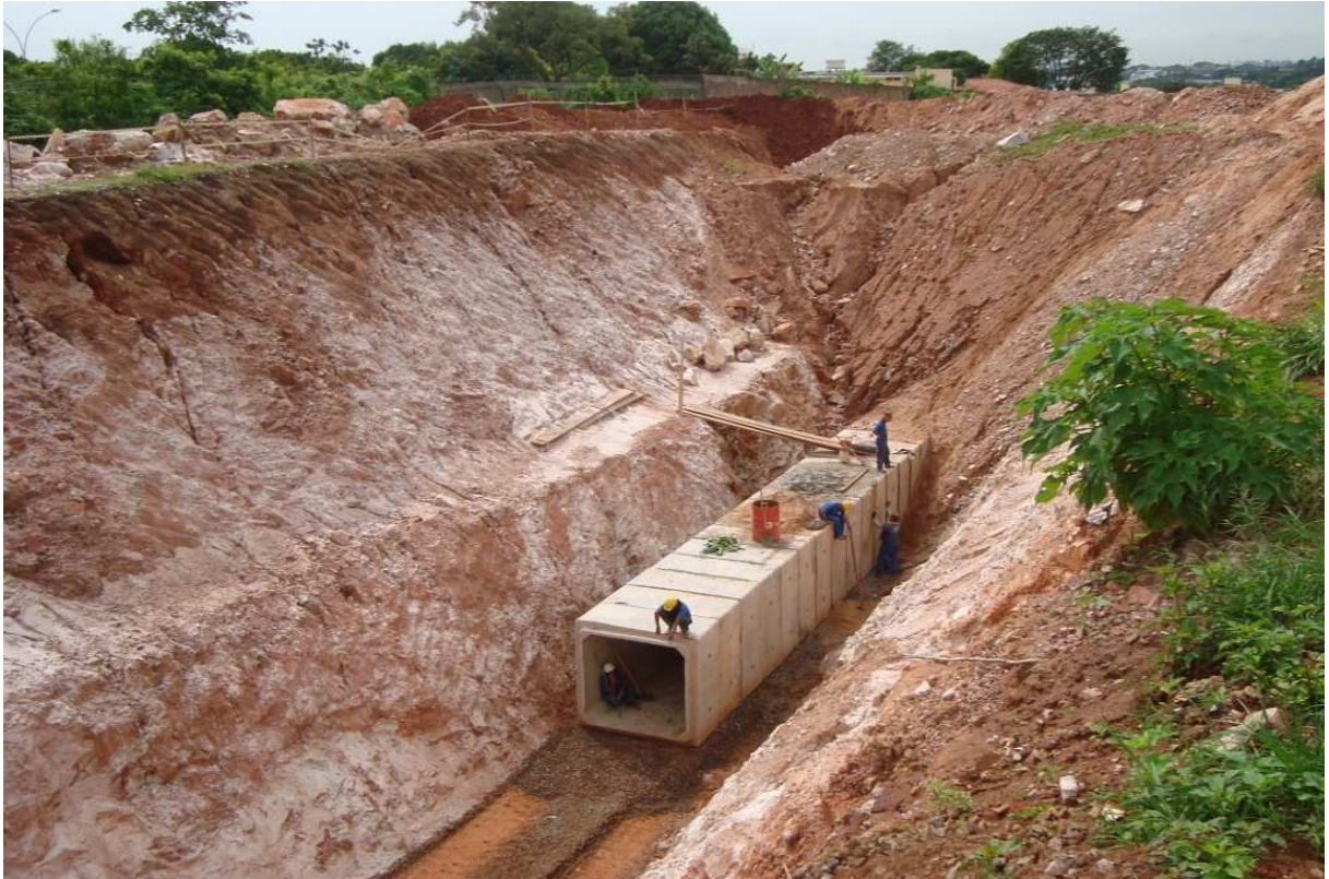
Figura 8.7 – Escavação em bancadas para galeria de águas pluviais de \varnothing 2000 mm, entre as bacias de detenção 2 e 3 do Parque Burle Marx. A obra escavou até 12 metros no pacote de quartzito, sendo necessária a utilização de explosivos (UTM SICAD 23L 188.047E / 8.256.339 N).
