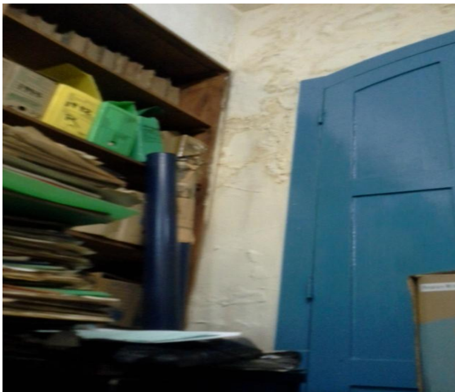
Imagem 2: Parede com infiltração e presença de mofo.
