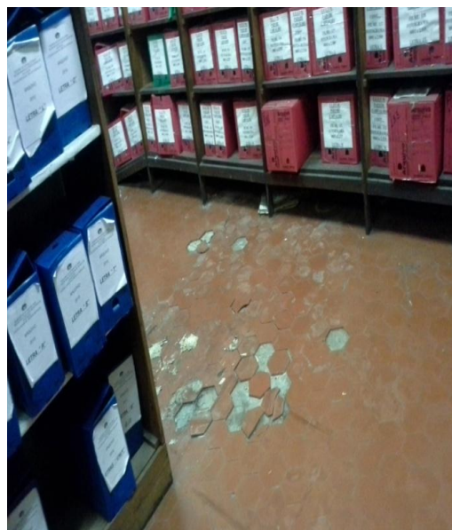
Imagem 4: Piso todo deteriorado
