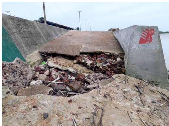
Figura 28- Destruição por erosão da rampa de acesso a praia de Marudá. Fotografia retirada em 15/03/2018.
