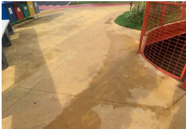
Figura 9: Surgimento de fissuras com 56 dias (Autores, 2025)
