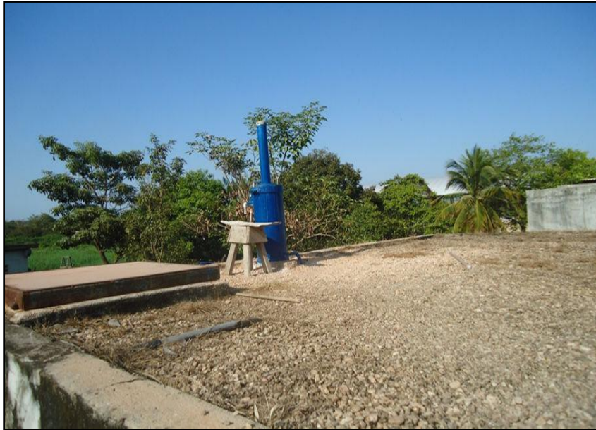
Figura 7 - Clorador no rap 150 m3
