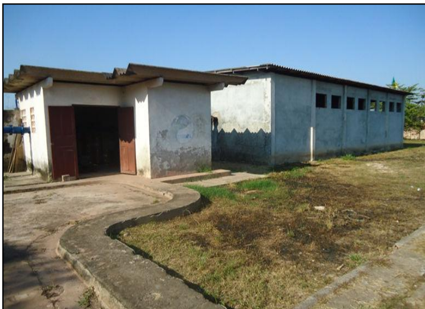
Figura 6 - Elevatória-3 e casa de máquinas inacabada
