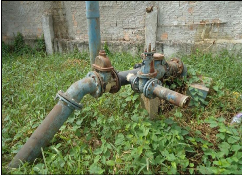
Figura 15 - Poço em situação precária
