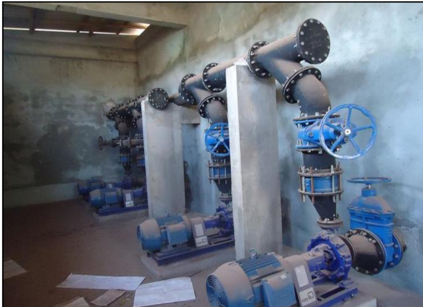
Figura 16 - Interior da casa de máquina - barrilete e conjuntos motor bombas em desuso
