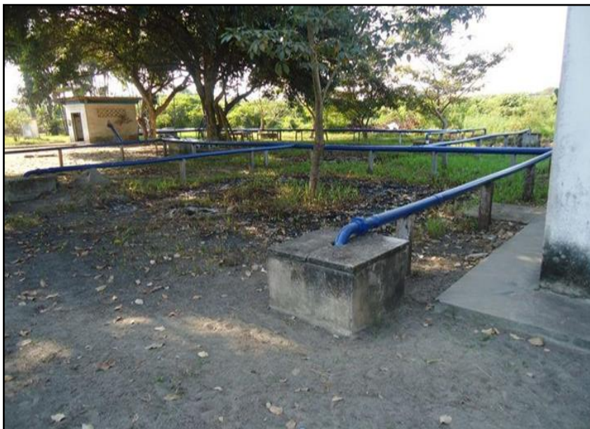
Figura 4 - Fotografia da bateria de poços
