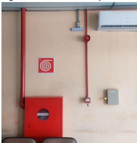
Figura 7: Sistema de detecção e alarme de incêndio(SDAI)
