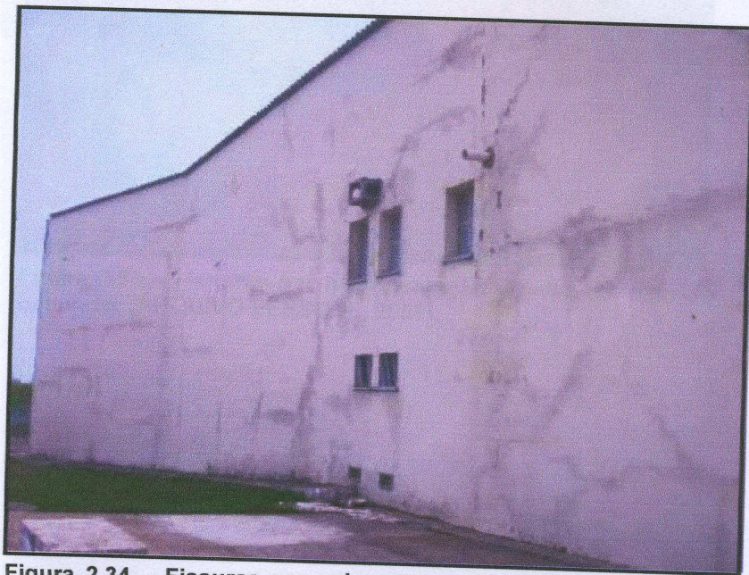
Figura 2.34 – Fissuras causadas por movimentação térmica em argamassas de revestimento. (ROCHA, 2008).
