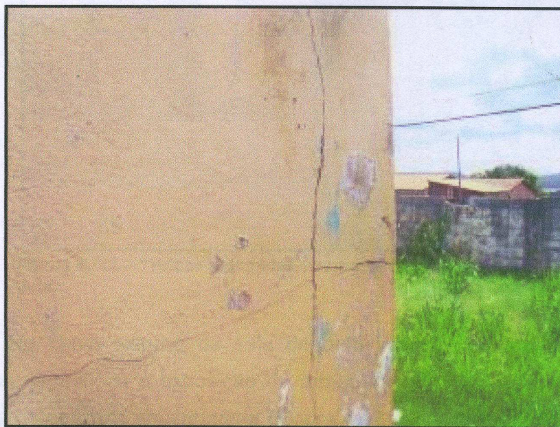
Figura 4. 10 – Trincas horizontais nas paredes externas das salas de aula.
