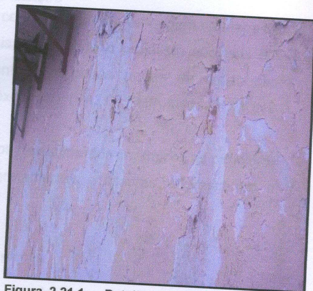
Figura 2.21.1 – Detalhe do descascamento da (ROCHA, 2008).
