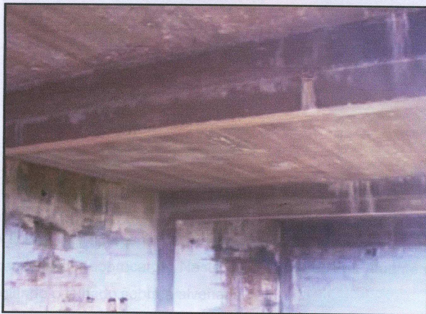
Figura 4. 68 – Vista lateral de vigas com lixiviação.
