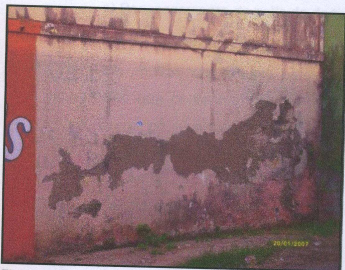
Figura 2.17 – Descolamento da pintura externa. (DIAS E ALMEIDA, 2008).
