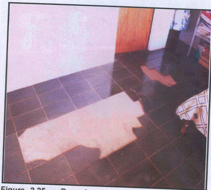
Figura 2.25 – Descolamento de placas devido à expansão por umidade. (PAES, 2007).
