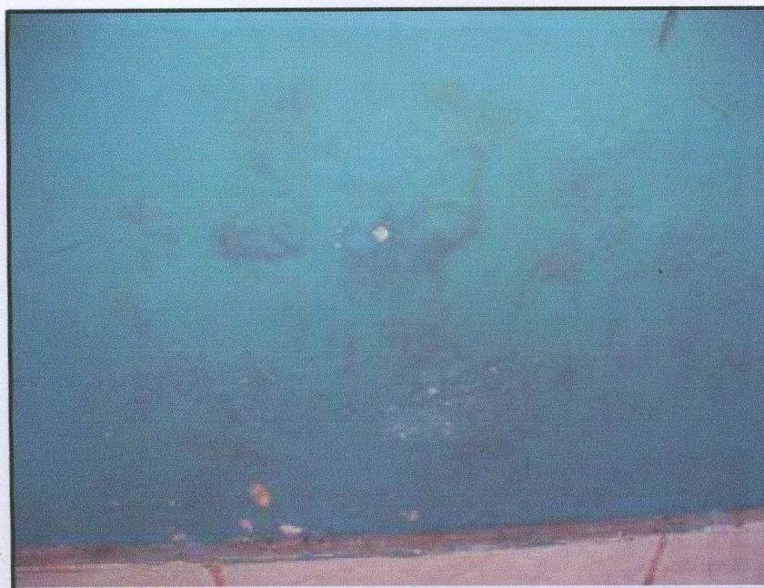
Figura 4. 53 – Parede externa com bolhas na pintura.
