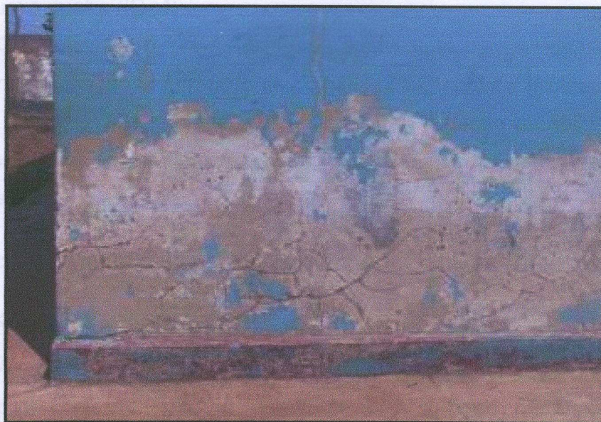
Figura 4. 32 – Parede externa com fissuras de retração da argamassa.
