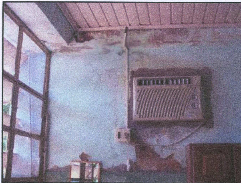
Figura 4. 86 – Parede com manchas de umidade e bolor.
