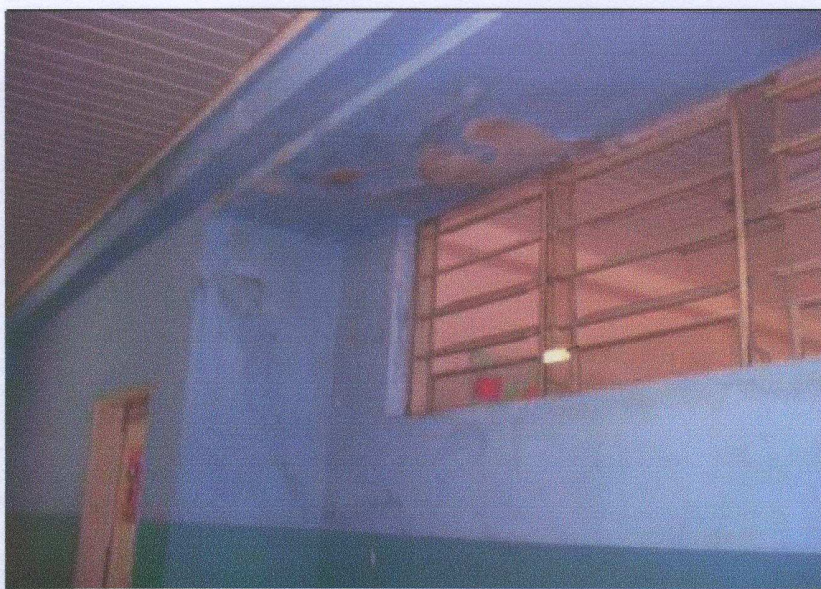
Figura 4. 102 – Presença de manchas de umidade no encontro da calha e alvenaria.
