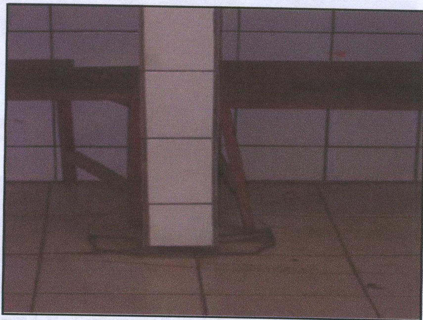
Figura 4. 19 – Desnível da bancada da sala de vídeo em relação ao piso da sala, ocasionado pelo recalque de fundação.
