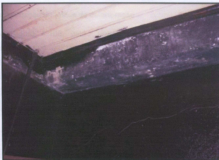
Figura 4. 103 – Eflorescência causada pela lixiviação dos compostos hidratados.
