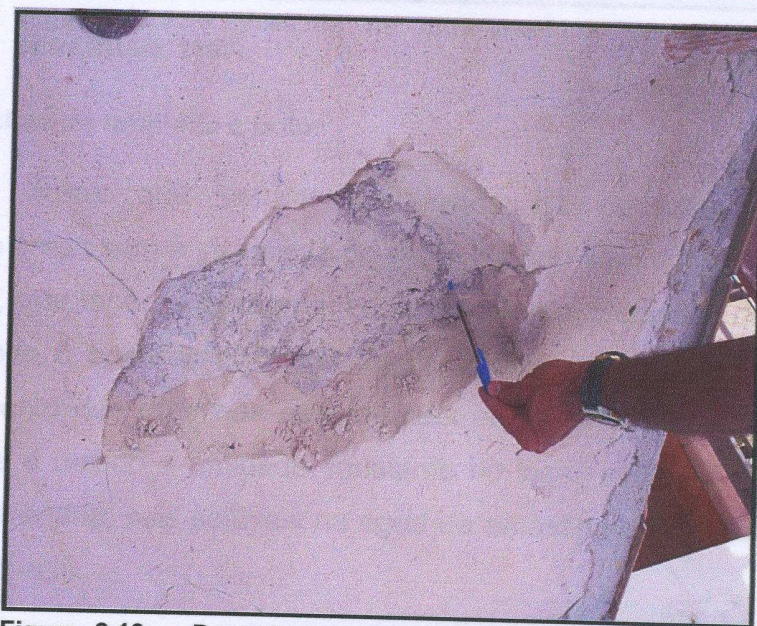
Figura 2.13 – Descolamento em placa do revestimento muito espesso. (PAES, 2007).
