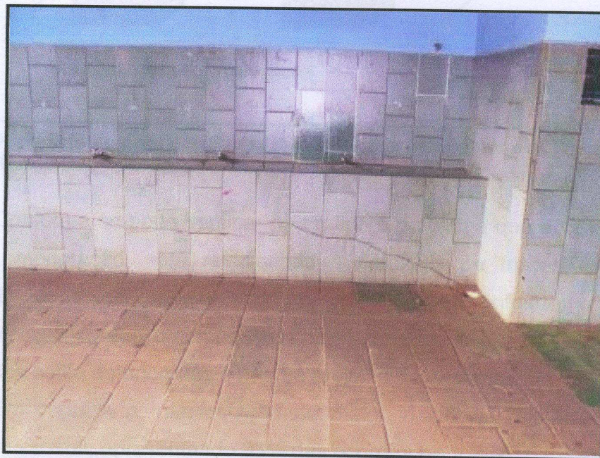
Figura 4. 115 – Fissura inclinada na placa cerâmica.
