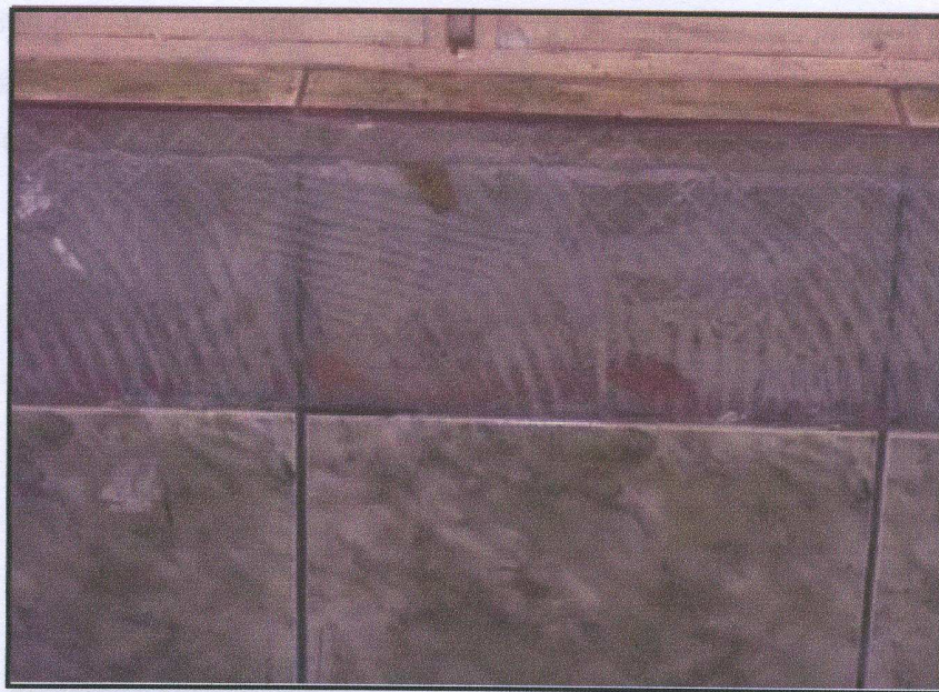
Figura 4. 38 – Falha de aderência entre a placa cerâmica e a argamassa.
