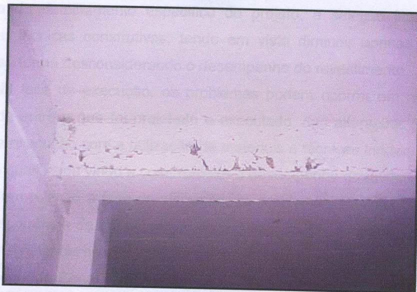
Figura 2.11 – Viga com segregação. (BRANDÃO, 2007).
