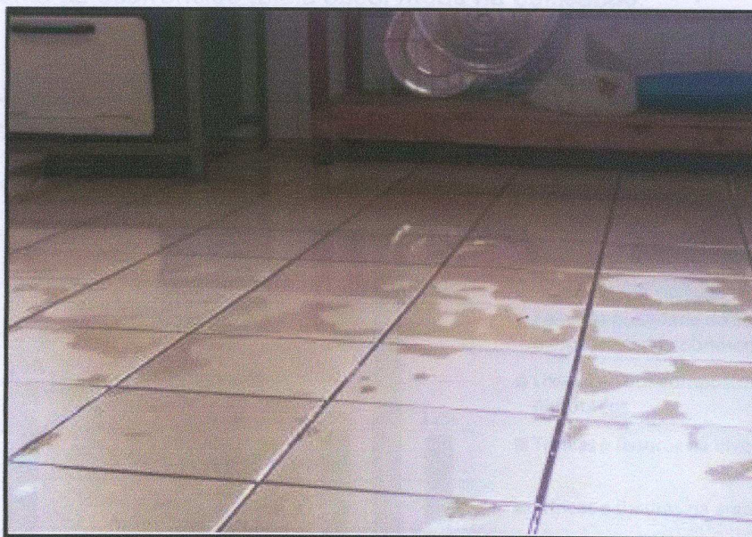
Figura 4. 78 – Piso da cozinha recalcado com acúmulo de água.
