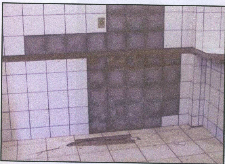
Figura 4.20 – Desnível do piso ocasionado pelo recalque de fundação.
