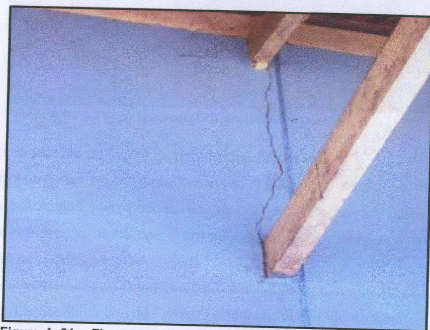
Figura 4. 61 – Fissura vertical de sobrecarga em alvenaria interna da escola.
