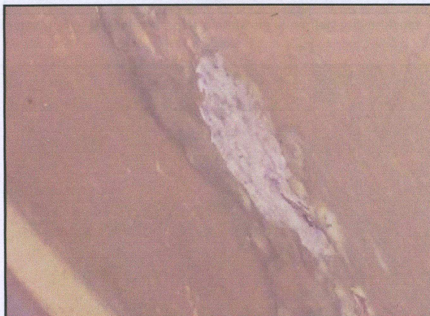
Figura 4. 25 – Formação de bolhas na parede externa da escola.
