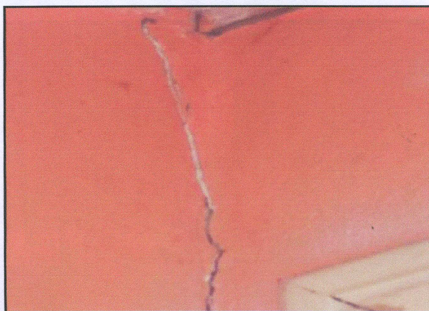
Figura 4.77 – Trinca vertical na parede externa do banheiro.
