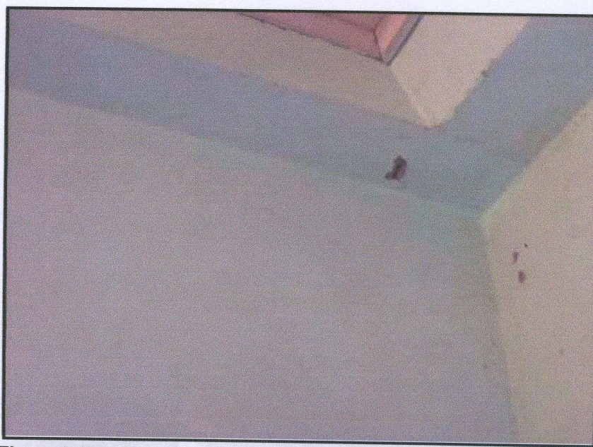
Figura 4. 89 – Armadura exposta com corrosão.
