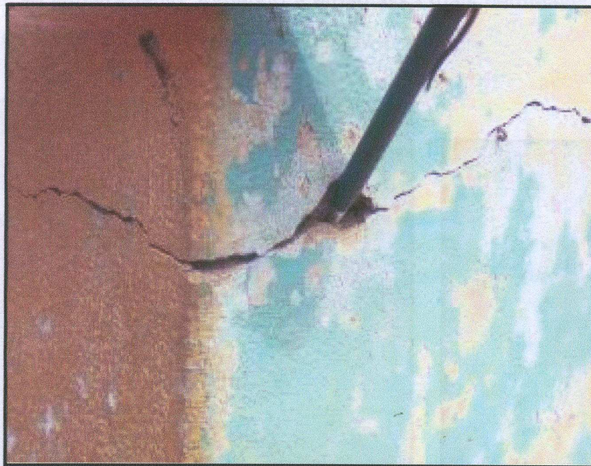
Figura 4. 11 – Trincas horizontais nas paredes externas das salas de aula.
