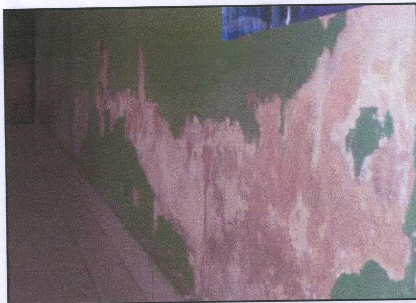
Figura 4. 48 – Parede externa com descolamento da película de tinta.
