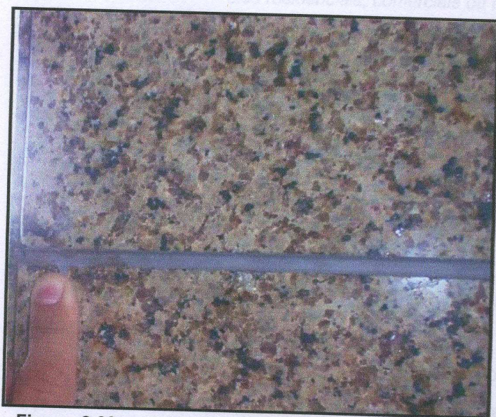
Figura 2.28 – Junta com perda de estanqueidade. (PAES, 2007).
