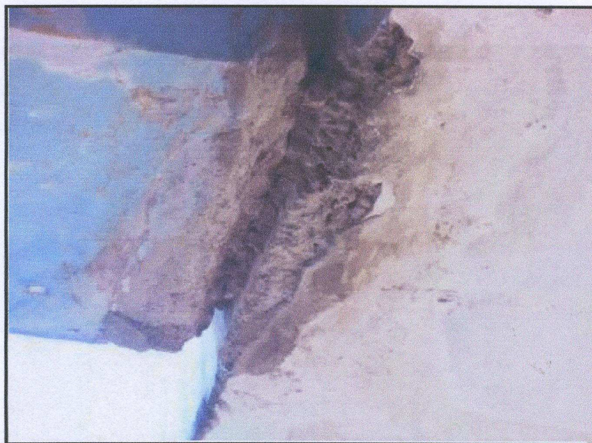
Figura 4. 36 – Laje com falha na espessura do cobrimento e má qualidade do concreto.
