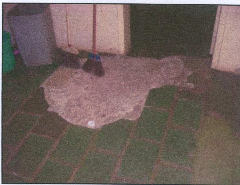
Figura 4. 97 – Destacamento de placas cerâmicas do piso.
