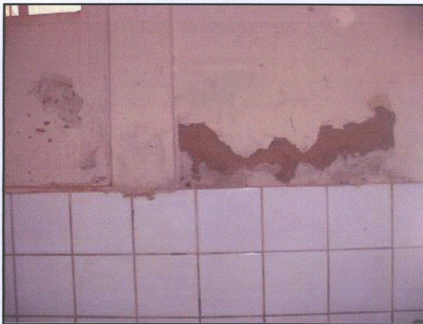
Figura 4. 26 – Descolamento da pintura em superfície pulverulenta.
