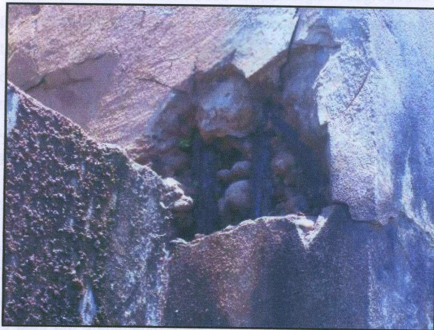
Figura 4. 43 – Falha na qualidade do concreto.
