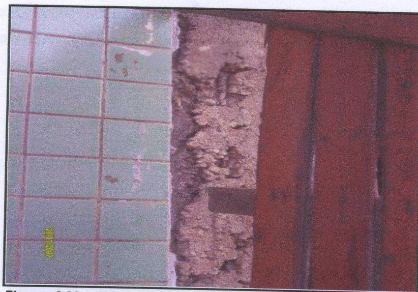
Figura 2.09 – Cobrimento insuficiente e má qualidade do concreto. (DIAS E ALMEIDA, 2008).
