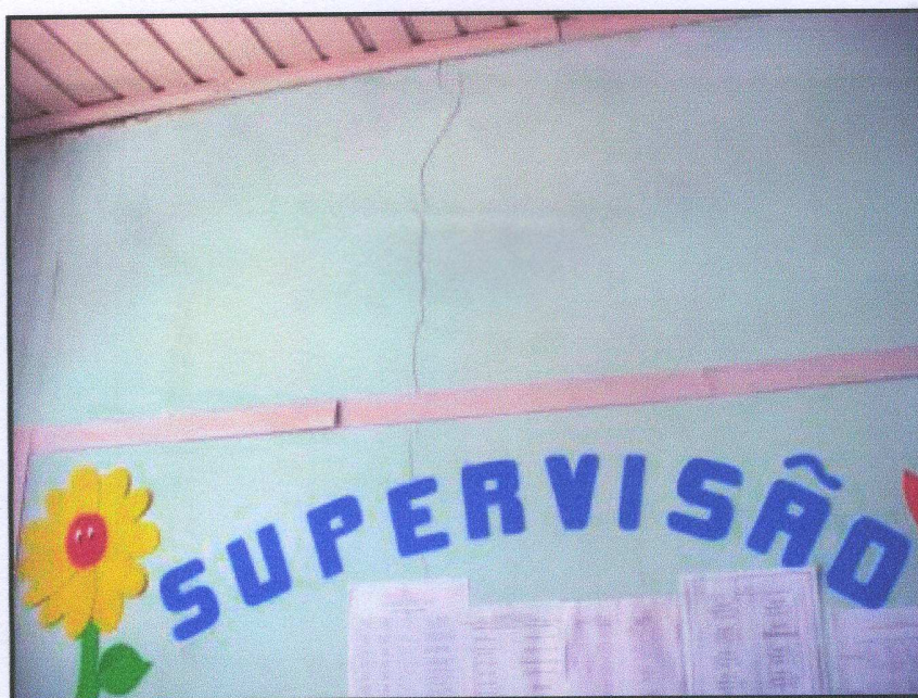
Figura 4. 84 – Fissura vertical na alvenaria.
