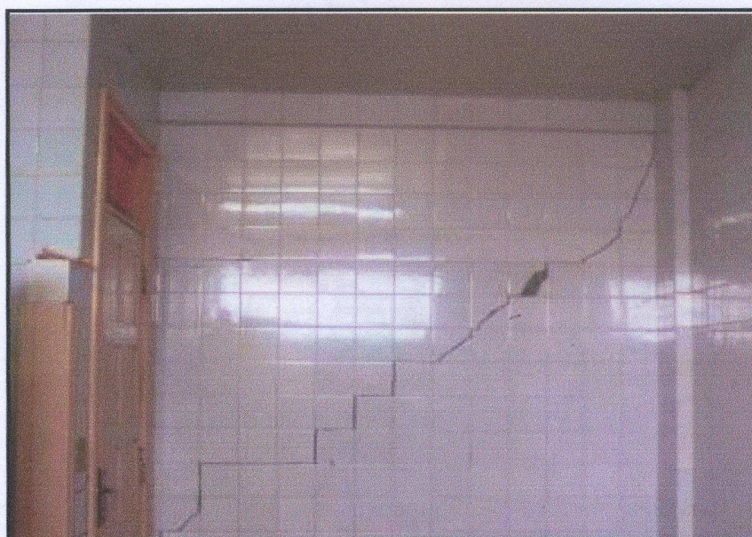
Figura 4.76 – Trinca na parede interna do banheiro.
