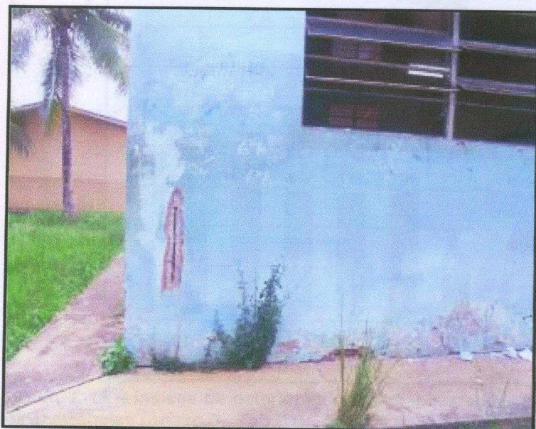
Figura 4.13 – Descolamento da argamassa e aparecimento de armadura com corrosão.
