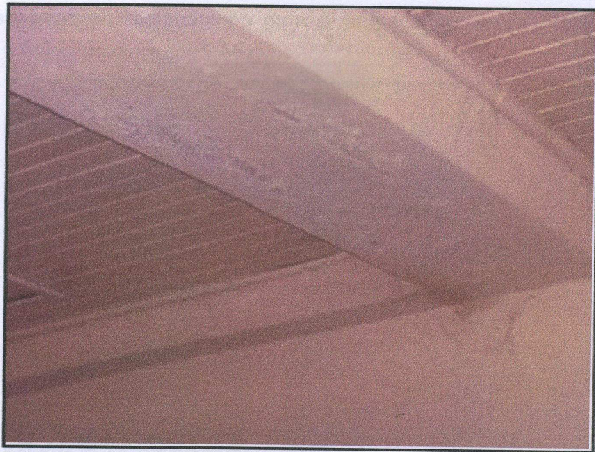
Figura 4. 94 – Vista inferior da calha com segregação do concreto.
