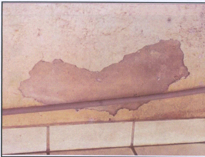
Figura 4. 04 – Descolamento da pintura juntamente com a argamassa de revestimento.
