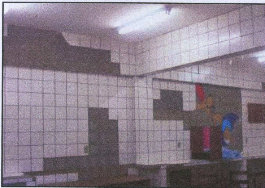
Figura 4. 17 – Destacamento de placas cerâmicas nas paredes internas na sala de vídeo da escola.
