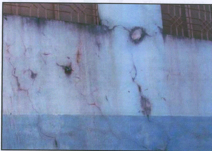
Figura 4. 23 – Fissuras típicas de movimentação térmica das argamassas.
