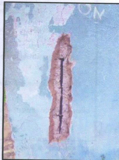
Figura 4.13.1 – Armadura com corrosão.
