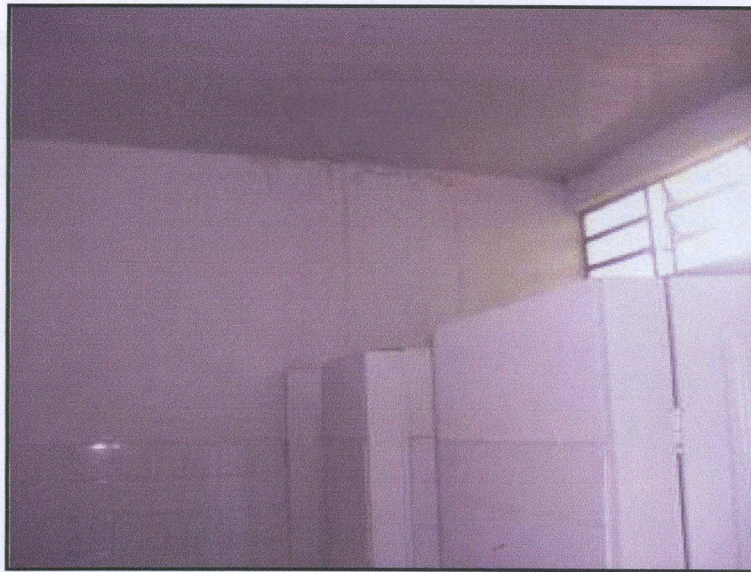
Figura 4. 30 – Infiltração na parede interna do banheiro.
