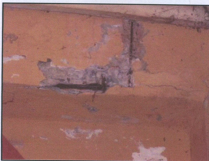
Figura 4. 99 – Armadura exposta com corrosão.
