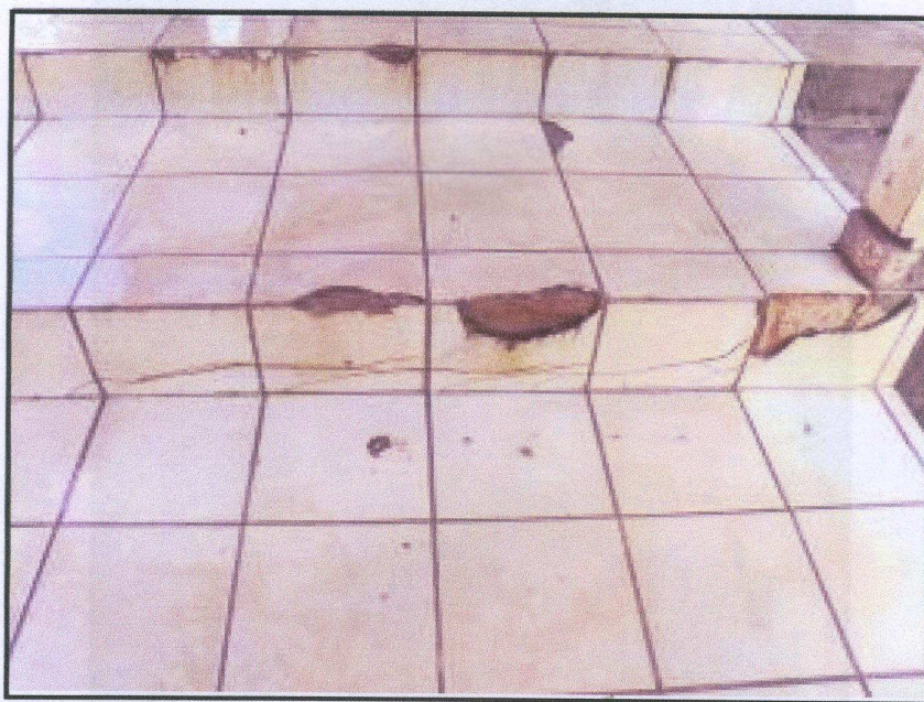
Figura 4. 07 – Destacamento de placas cerâmicas e aparecimento de fissuras horizontais.
