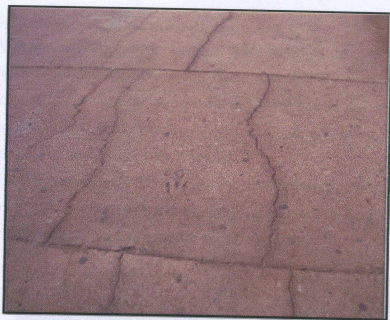
Figura 2.35 – Fissuras por movimentação térmica em piso de concreto. (ARQUIVO PESSOAL, 2008).
