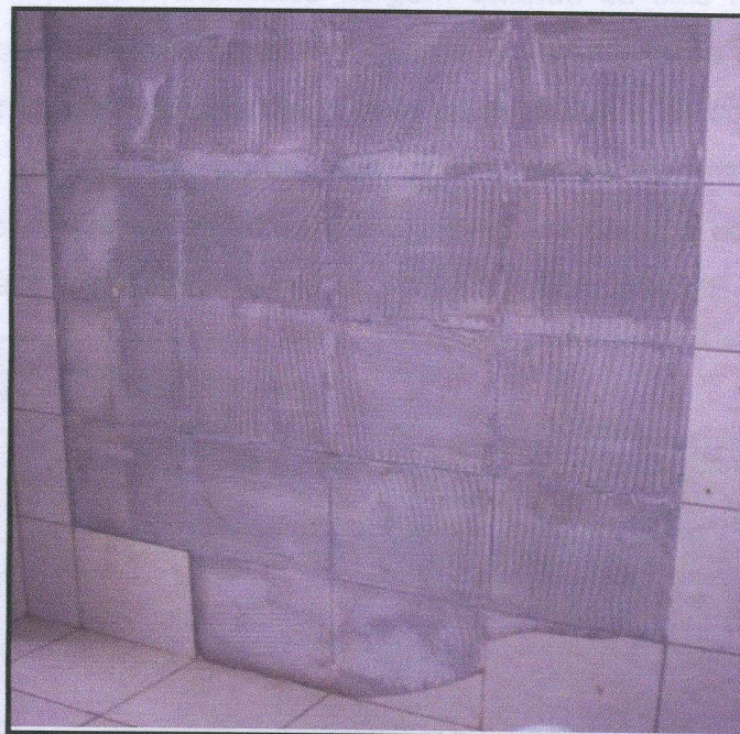
Figura 2.24 – Descolamento de placas devido à ultrapassagem do tempo em aberto para assentamento das placas. (ROCHA, 2008).
