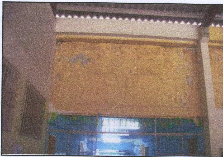
Figura 4. 40 – Descascamento da pintura decorrente da umidade constante no local.
