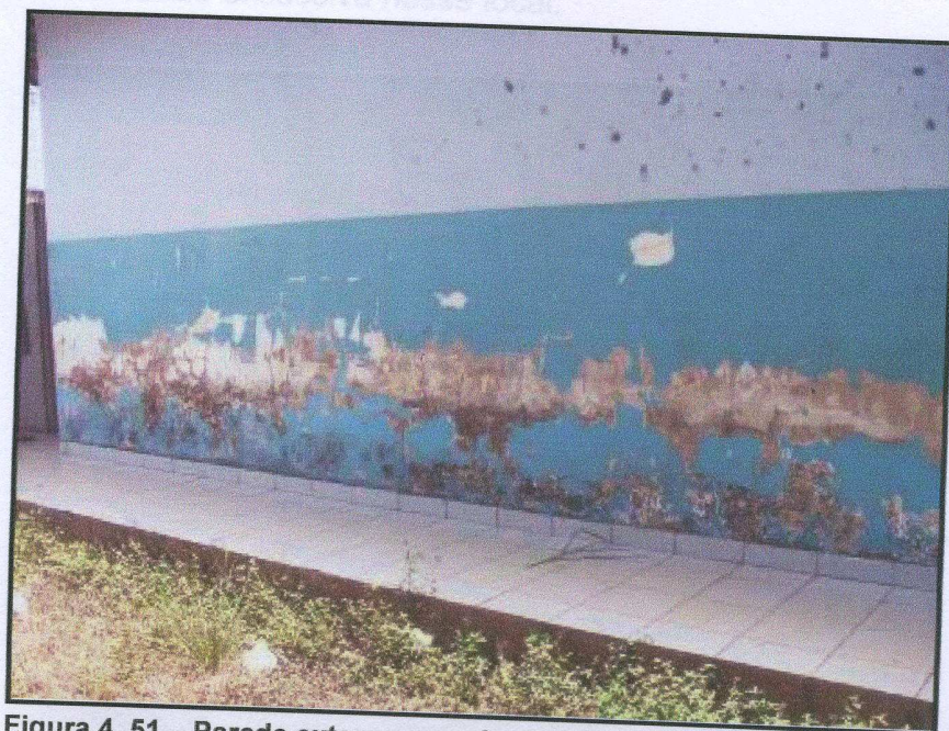
Figura 4. 51 – Parede externa com descascamento da pintura.
