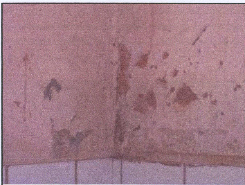
Figura 4. 27 – Descolamento da pintura em superfície pulverulenta.
