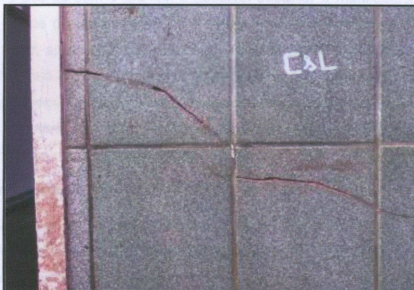
Figura 4. 62 – Trinca horizontal no revestimento cerâmico.
