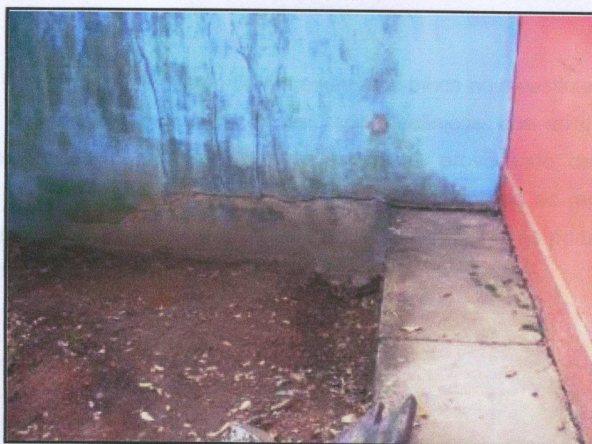
Figura 4. 60 – Muro com trinca inclinada apresentando grande dimensão na abertura.
