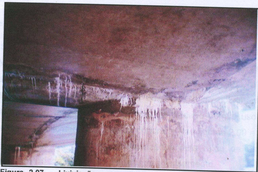
Figura 2.07 – Lixiviação no concreto, formação de estalactite. (OLIVEIRA, 2008).
