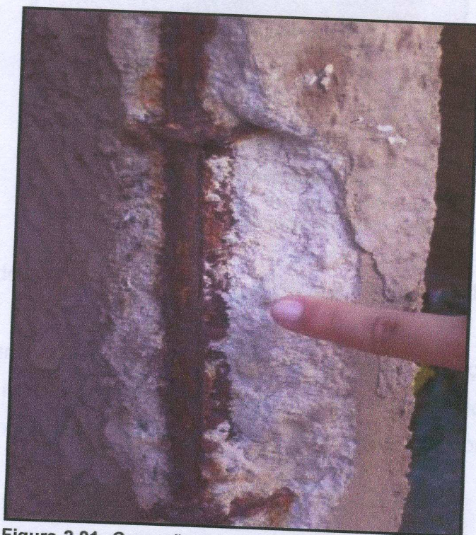
Figura 2.01- Corrosão da armadura no pilar. (DIAS E ALMEIDA, 2008).
