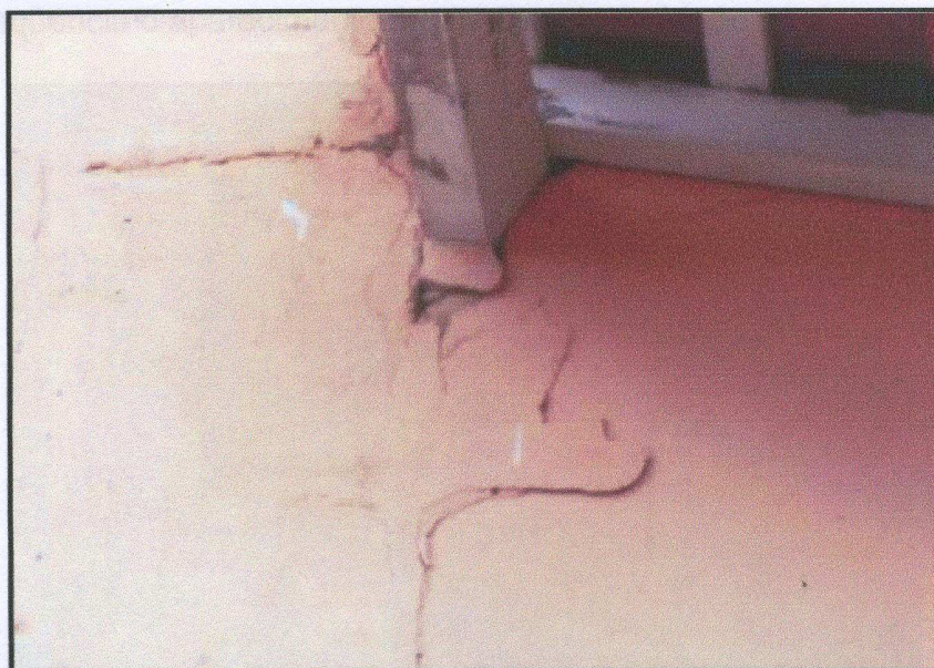
Figura 4. 71 – fissuras verticais na alvenaria.
