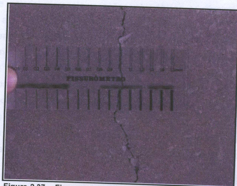
Figura 2.37 – Fissuras por cura térmica do concreto. Pesquisa
