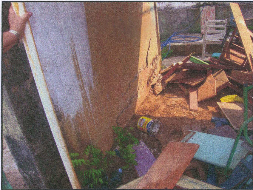
Figura 4. 106 – Base da caixa d'água antes da reforma.
