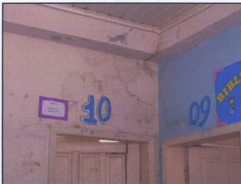
Figura 4. 92 – Paredes com manchas de umidade.
