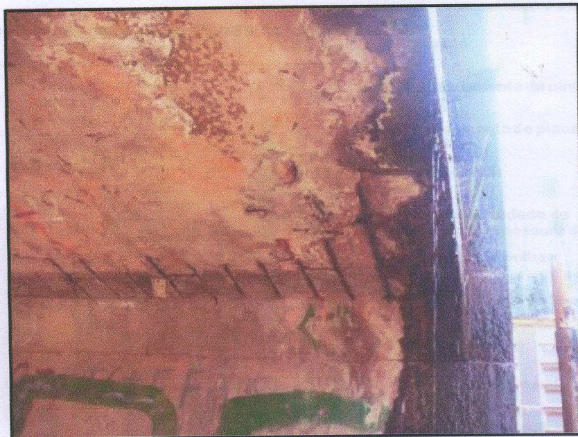
Figura 4. 42 – Falha na qualidade do concreto e cobrimento insuficiente.
