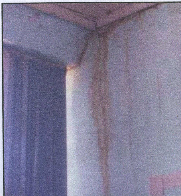
Figura 4. 85 – Manchas de úmida de e bolor.
