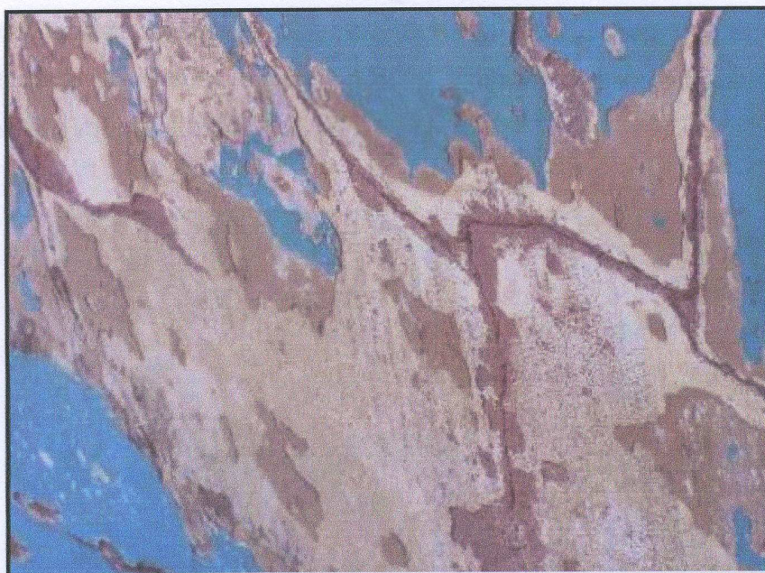
Figura 4. 52 – Parede externa com descascamento da pintura e fissuras de retração da argamassa.
