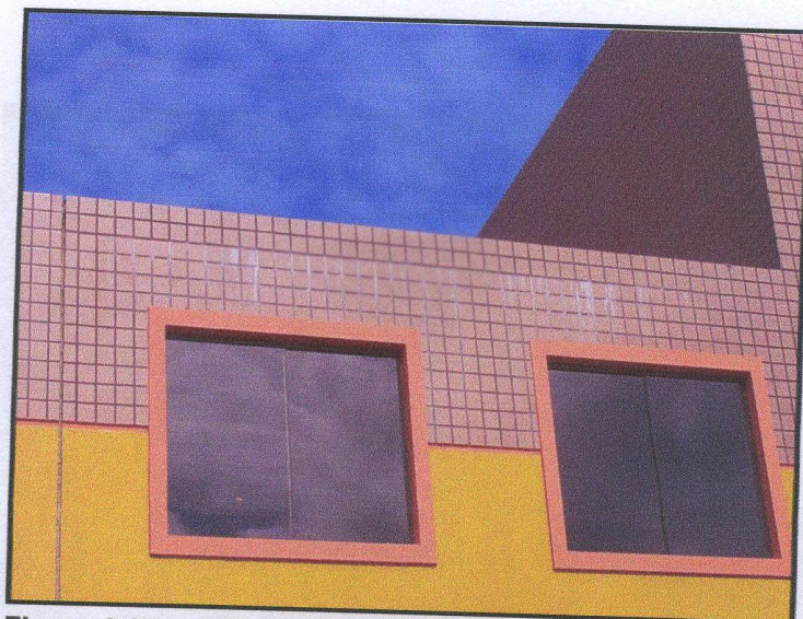
Figura 2.27 – Eflorescência na fachada revestida com pastilhas. (PAES, 2007).
