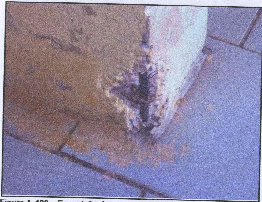
Figura 4. 100 – Exposição da armadura do pilar.
