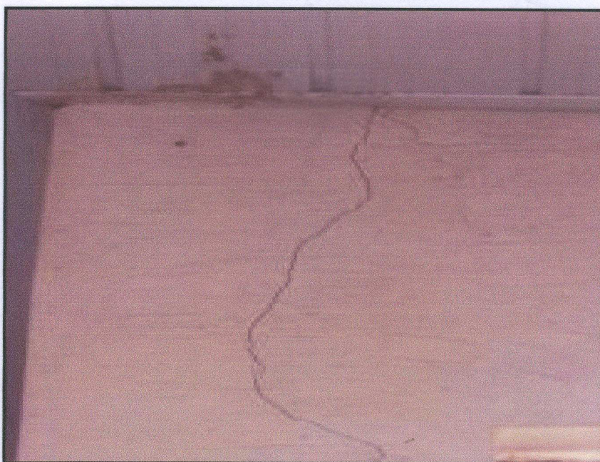
Figura 4. 28 – Fissura vertical na parede interna da sala de aula.
