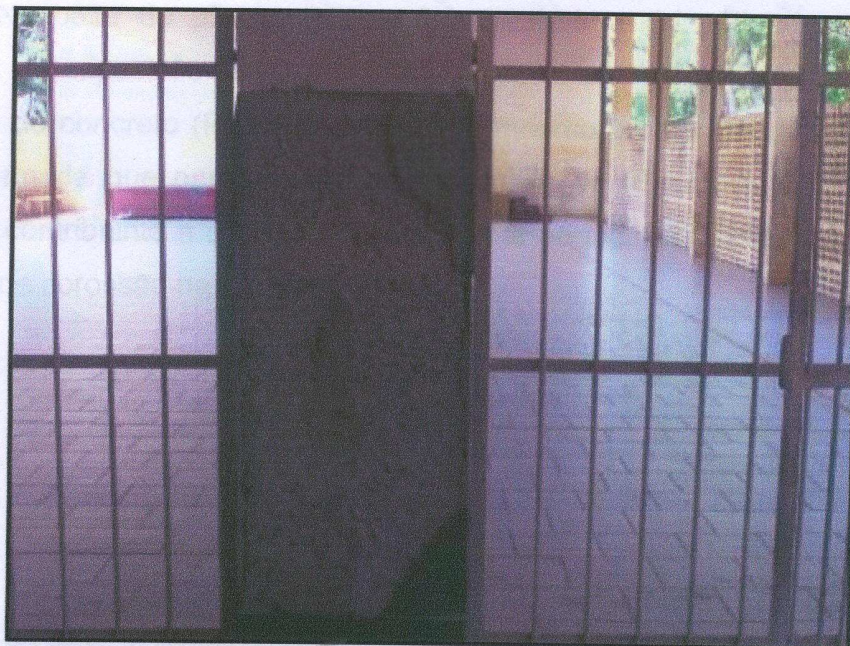
Figura 4. 98 – Destacamento de placas cerâmicas do pilar.
