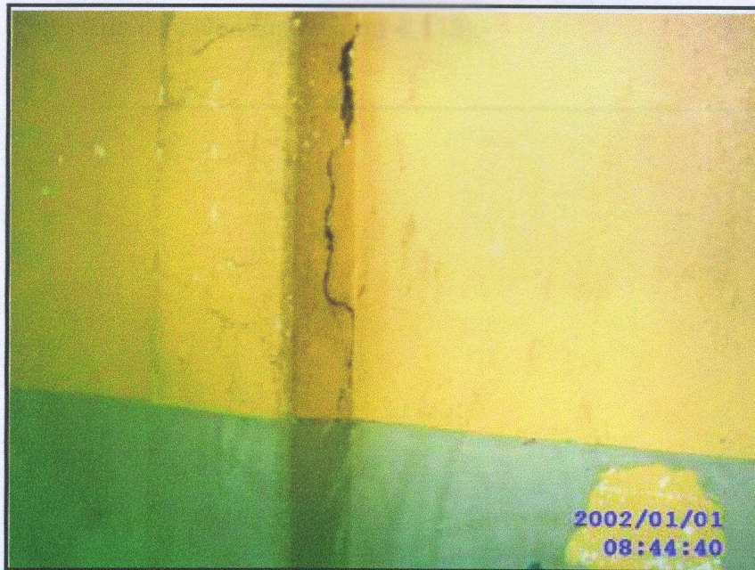
Figura 4. 111 – fissura entre pilar e alvenaria.
