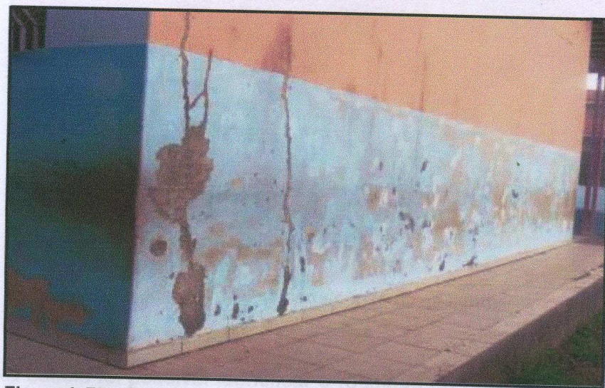
Figura 4. 75 – Parede externa com descascamento da pintura.
