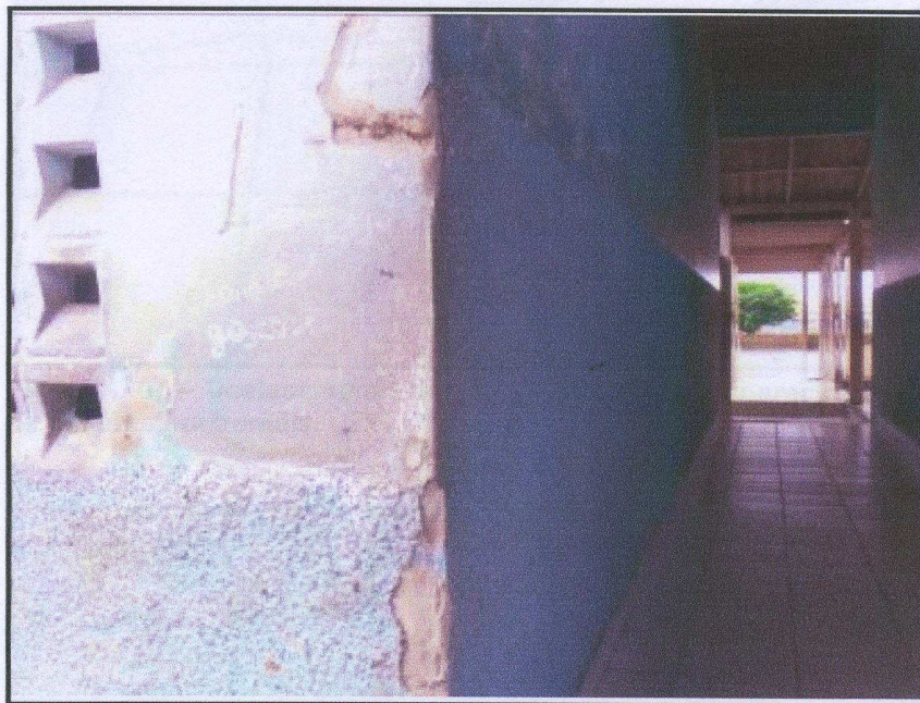
Figura 4. 06 – Descolamento da argamassa de revestimento no canto externo da alvenaria.
