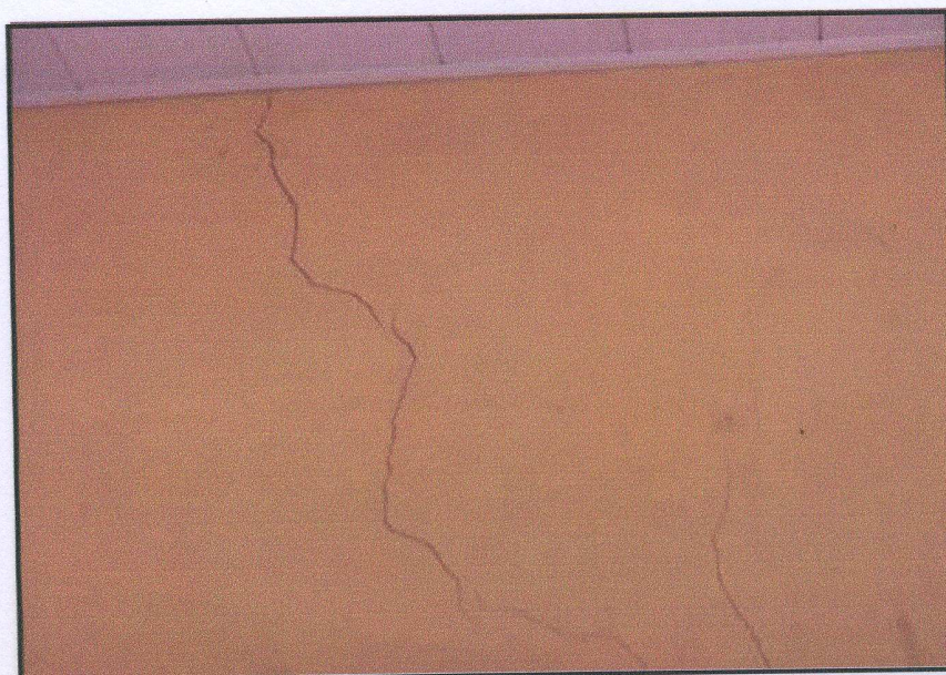
Figura 4. 49 – Parede interna com fissuras verticais.
