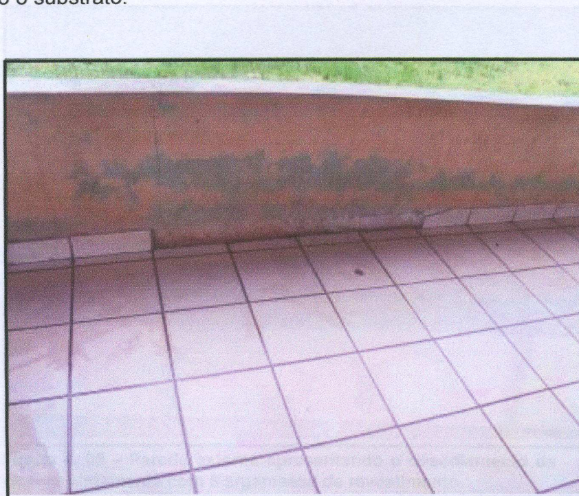
Figura 4. 03 – Destacamento de placas cerâmicas do rodapé da área de recreação.
