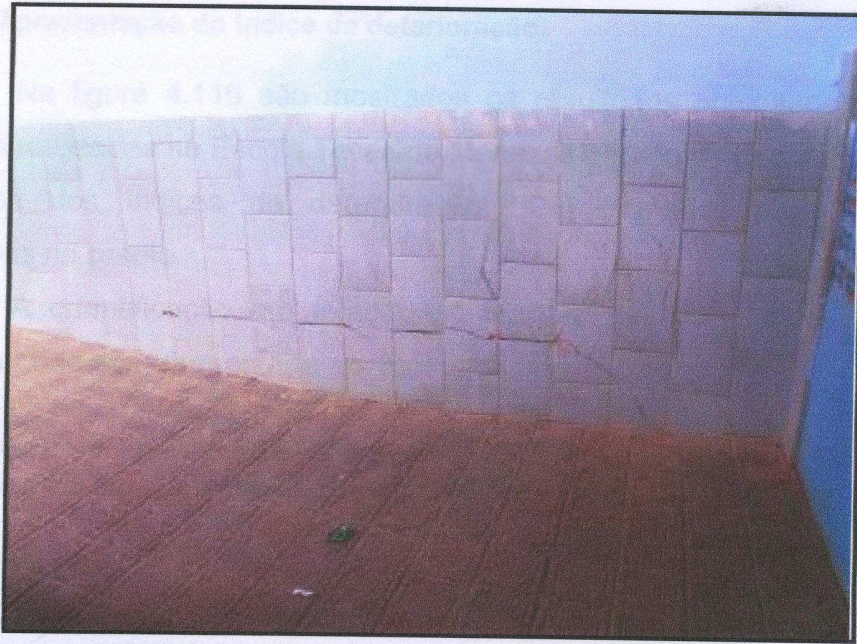
Figura 4. 114 – Fissura inclinada na alvenaria.
