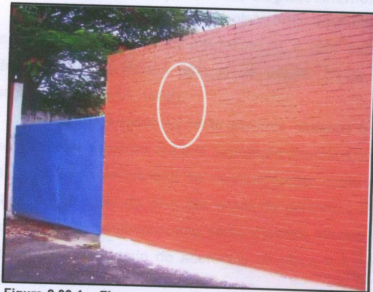
Figura 2.33.1 – Fissura vertical com abertura de 2 a 3mm, configuração típica de fissuras causadas por movimentação térmica em muros. (ROCHA, 2008).
