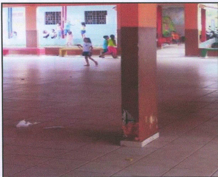
Figura 4. 67 – Pilar interno com corrosão da armadura.
