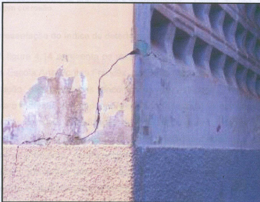
Figura 4. 12 – Trincas inclinadas nas paredes externas das salas de aula.
