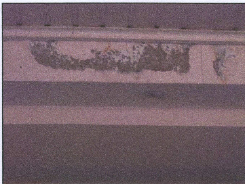
Figura 4. 93 – Vista lateral da calha com segregação do concreto.
