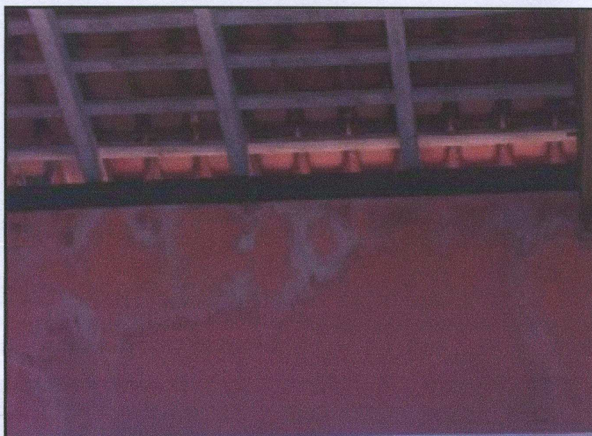
Figura 4. 15 – Parede interna do pátio de recreação da escola apresentando manchas esbranquiçadas.
