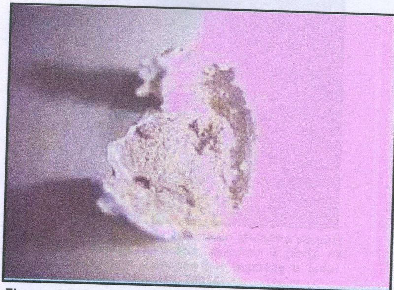
Figura 2.14 – Vesícula na argamassa de revestimento. (BRANDÃO, 2007).
