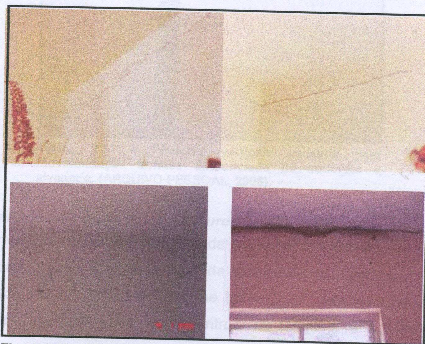
Figura 2.31 – Fissuras causadas por movimentação térmica em lajes. (OLIVEIRA, 2008).
