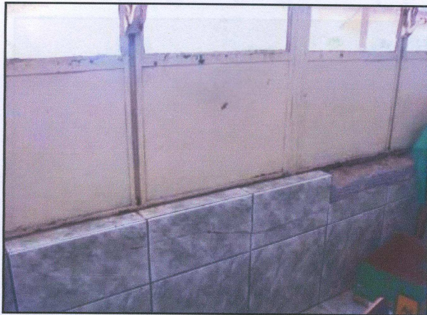
Figura 4. 37 – Descolamento de cerâmica dos peitoris das salas de aula.
