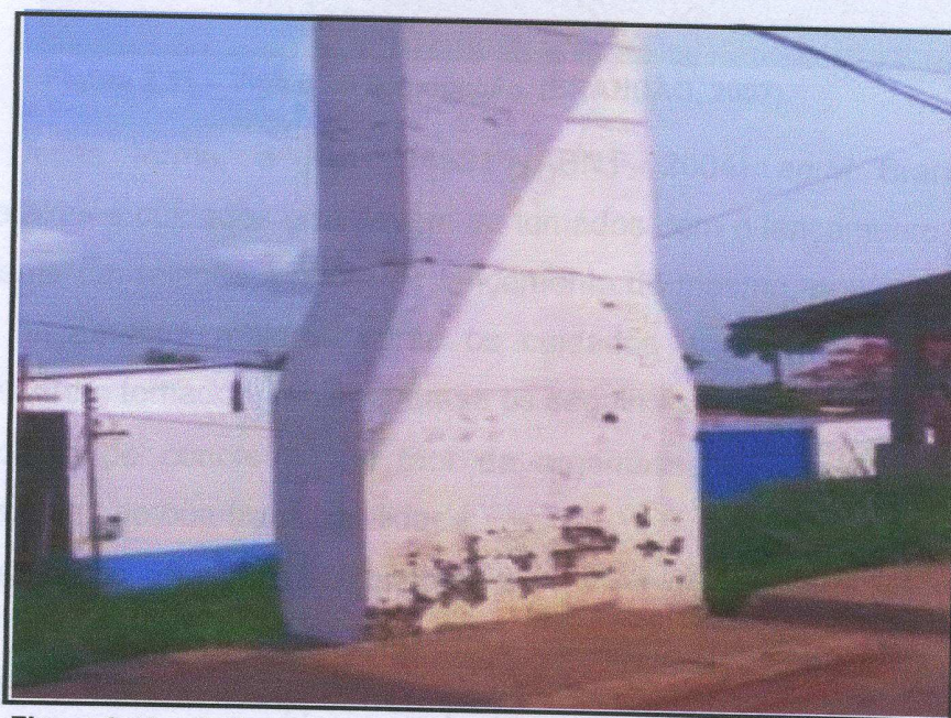
Figura 2.10 – Falha na espessura do revestimento. (SOARES E SANTOS, 2008).
