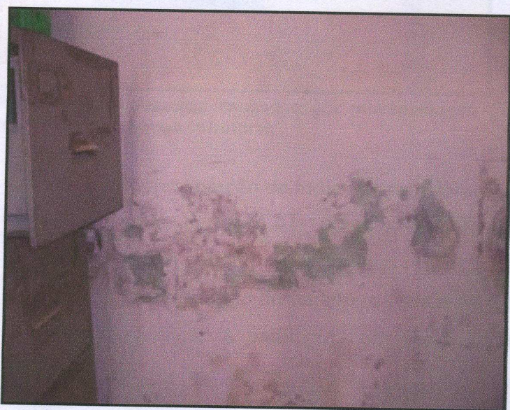
Figura 4.45 – Descascamento da pintura.
