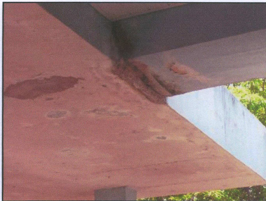
Figura 4. 35 – Laje com problemas de umidade.
