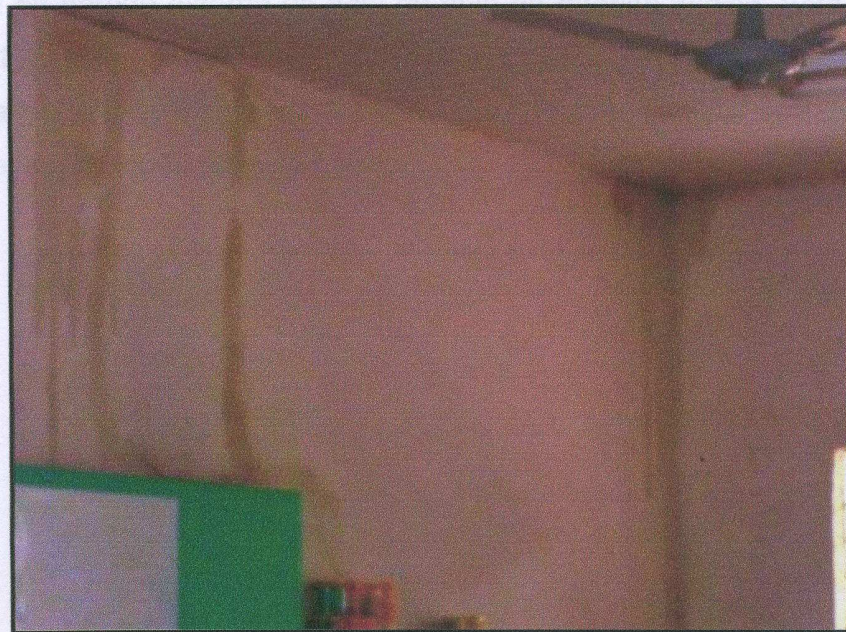
Figura 4. 73 – Infiltração na parede da sala de aula.
