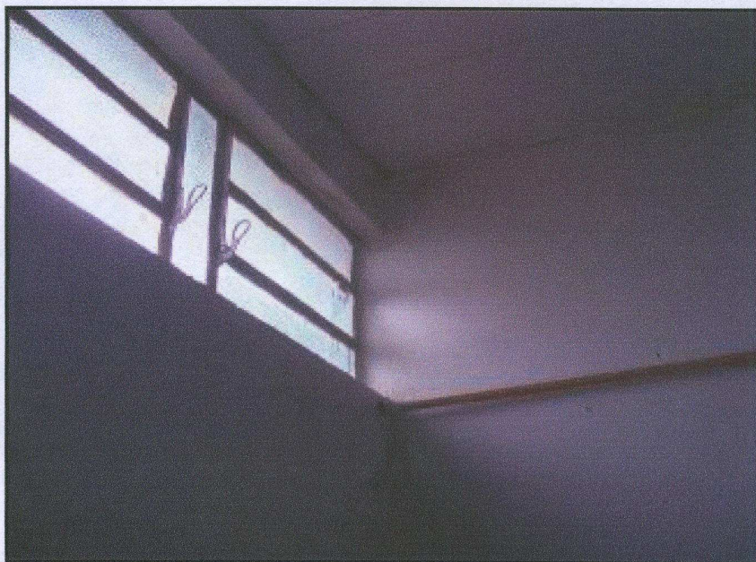
Figura 4. 29 – Infiltração no encontro de viga e alvenaria interna do banheiro.
