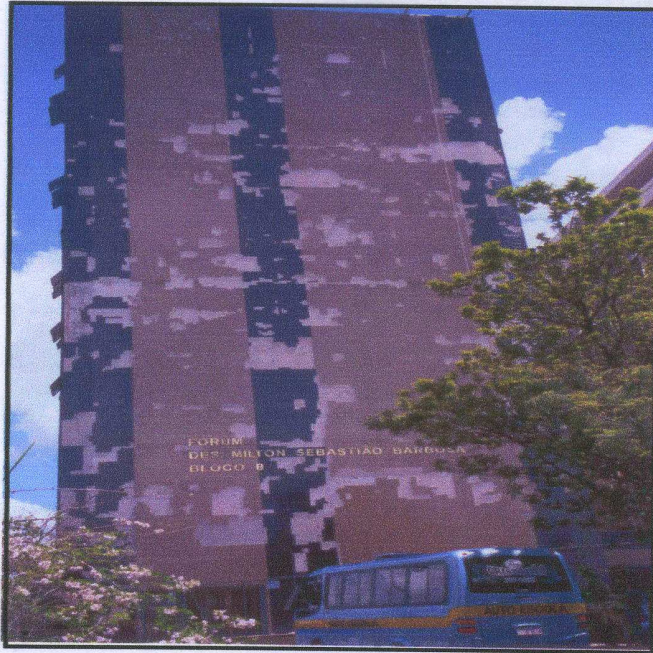
Figura 2.23 – Destacamento de placas devido ausência de detalhes construtivos (Juntas de movimentação). (PAES, 2007).
