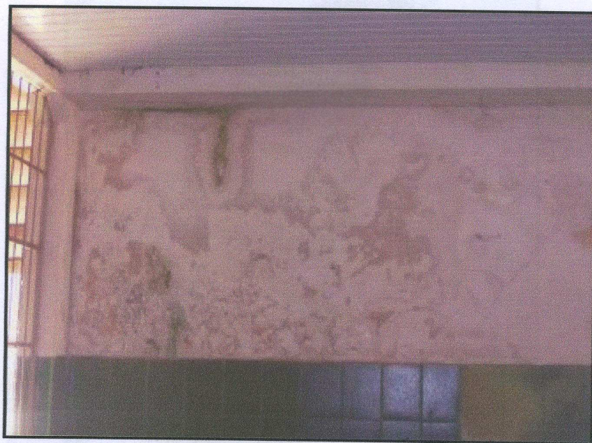
Figura 4. 39 – Manchas de umidade na parede interna das salas de aula.
