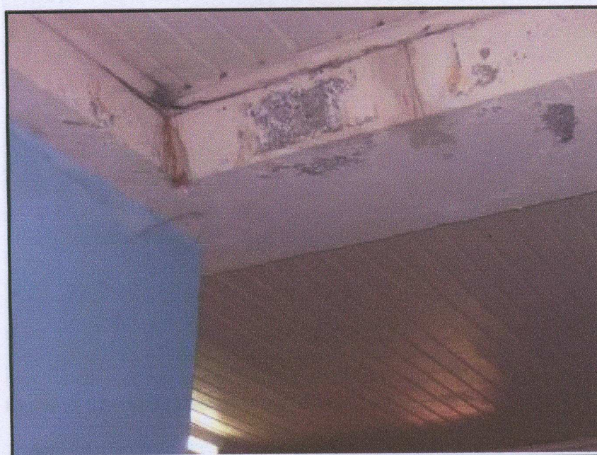
Figura 4. 91 – Vista lateral da calha com manchas de umidade.
