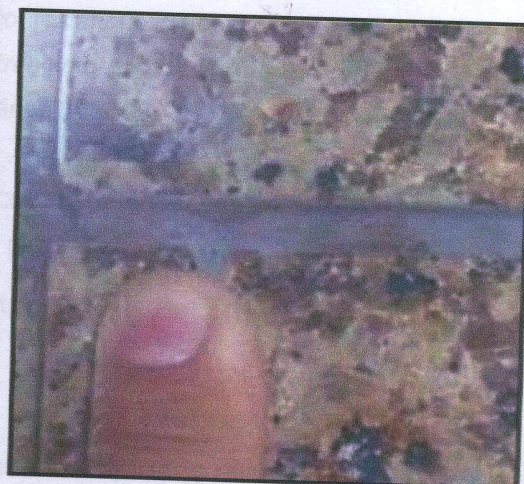
Figura 2.28.1 – Junta de deterioração. (PAES, 2007).
