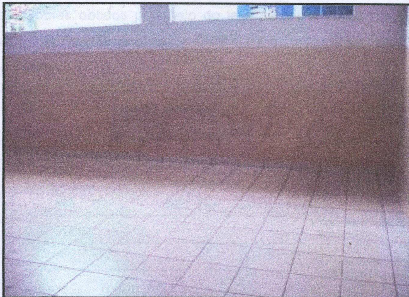
Figura 4. 31 – Infiltração nas paredes internas das salas de aula.
