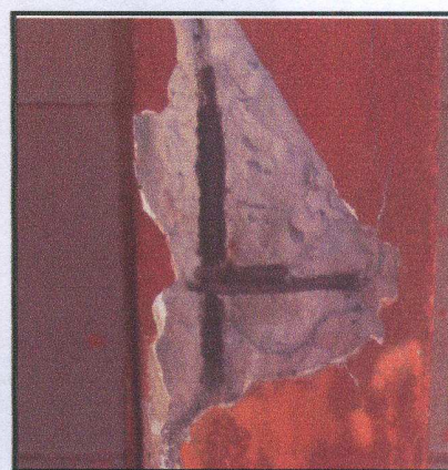
Figura 4. 67.1 – Detalhe do pilar com corrosão da armadura.
