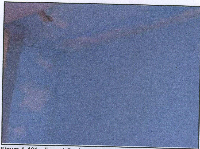
Figura 4. 101 – Exposição da armadura da calha
