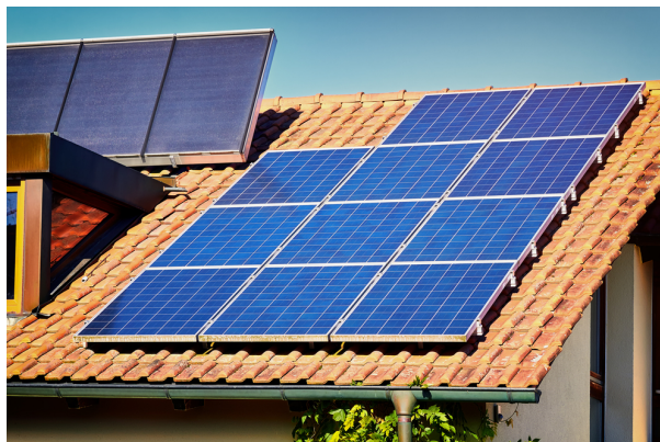
Figura 2.16 – Painel fotovoltaico instalado
