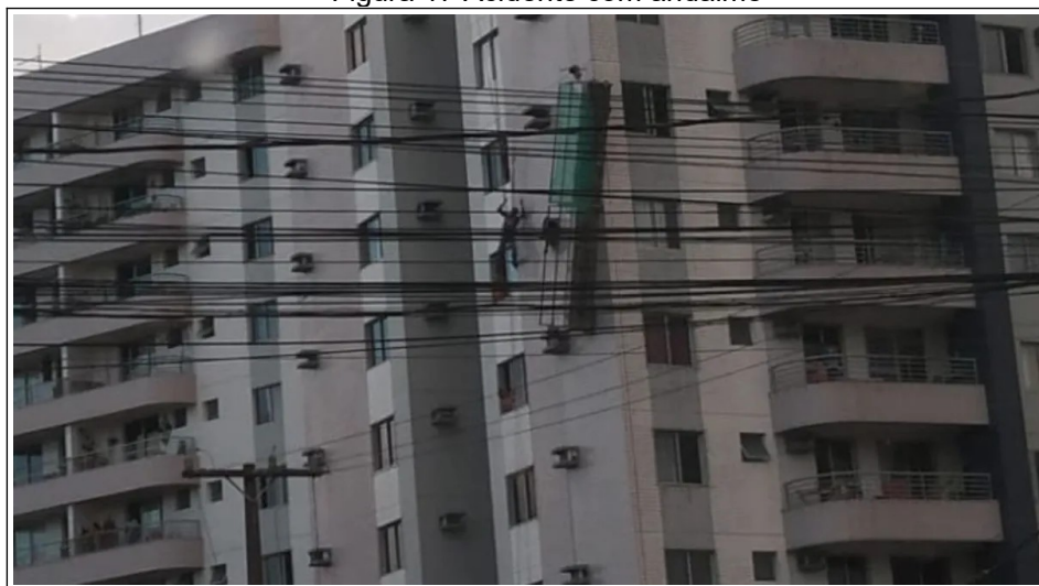
Figura 17 Acidente com andaime
