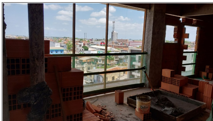
Figura 20: Guarda corpo provisório
