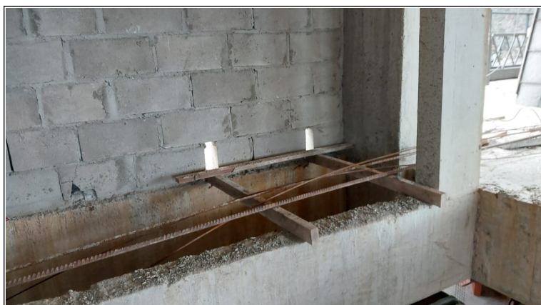
Figura 22: Abertura de laje sem proteção
