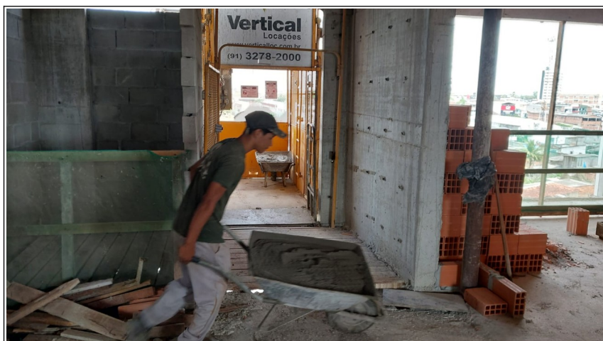
Figura 25: Trabalhador sem EPI
