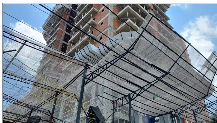
Figura 19: EPC instalados em obra em Belém
