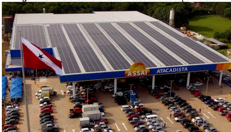
Figura 23 Placas fotovoltaicas em cobertura de supermercado
