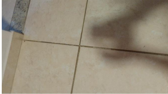
Figura 3. Destacamento de rejunte.
