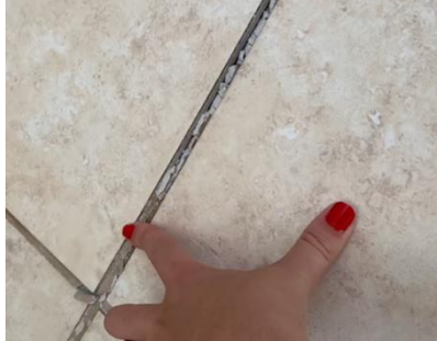
Figura 5. Degradação das juntas e movimentação da peça (fragmento de vídeo).
