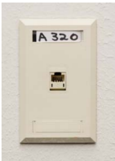
Figura 15 - Exemplo de uma tomada de telecomunicação identificada
