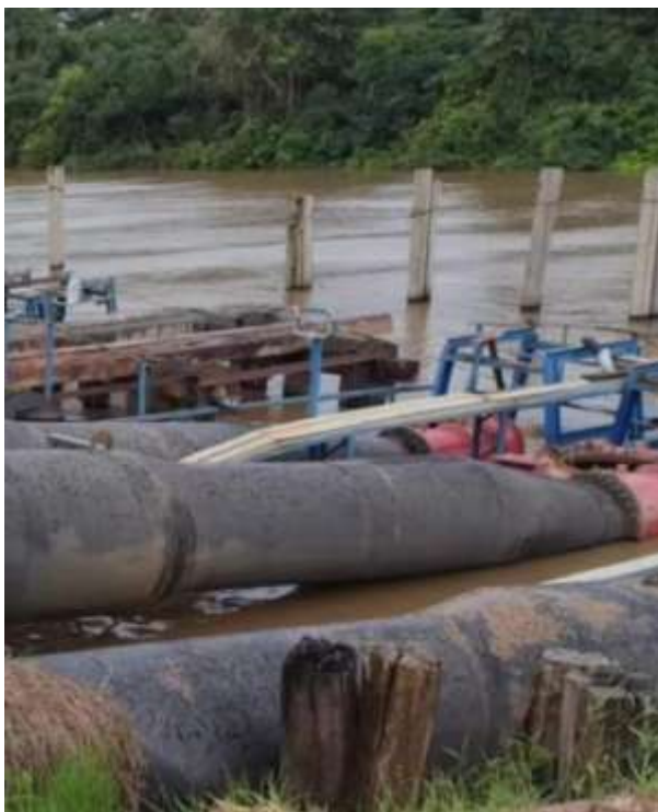
Figura 5. Bombas de sucção do rio Arari
