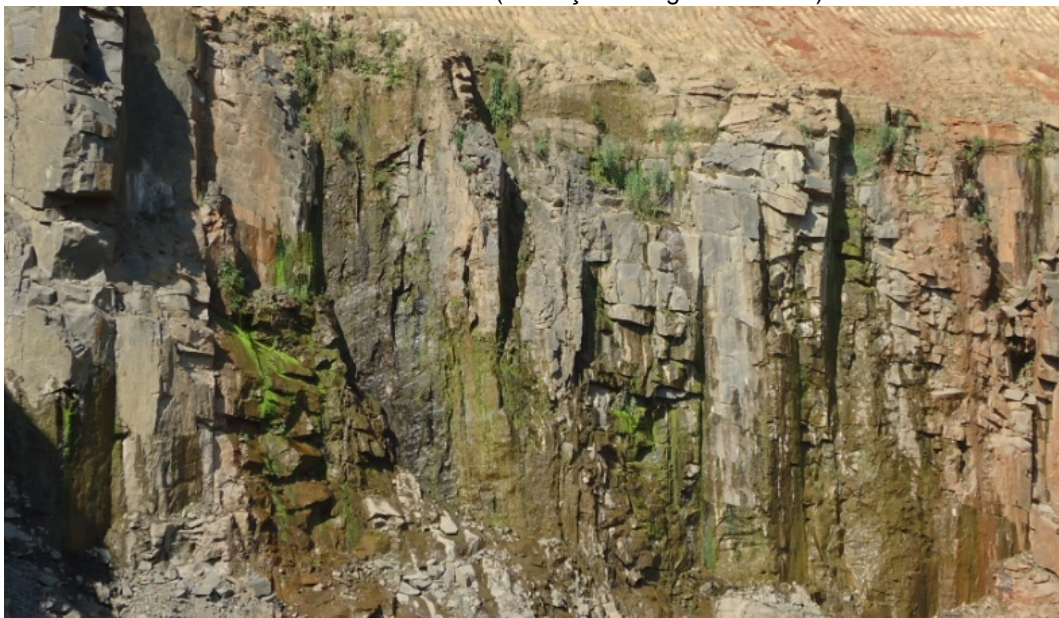
Foto 3 – Detalhe da porção nordeste da cava com percolação d'água no maciço rochoso proveniente da interface solo/rocha (infiltração de água de chuva).
