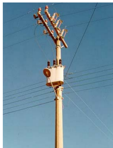
Figura 2.15 – Transformador de Distribuição
