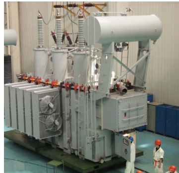
Figura 2.11 – Transformador de alta potência.
