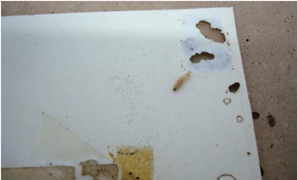
Figura 11: Perfurações devido a ataques de cupins. Fonte: TEIXEIRA, 2012 16
