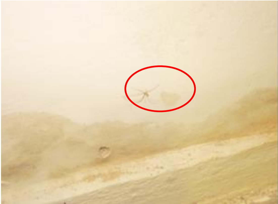
Figura 31: Aracnídea, parede perto do chão e mancha de umidade. Fonte: Acervo pessoal
