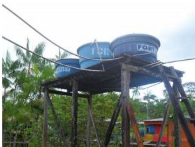
Figura 25 - Reservatórios elevados para escola da Vila Luciana na Zona Rural de Anajás.
