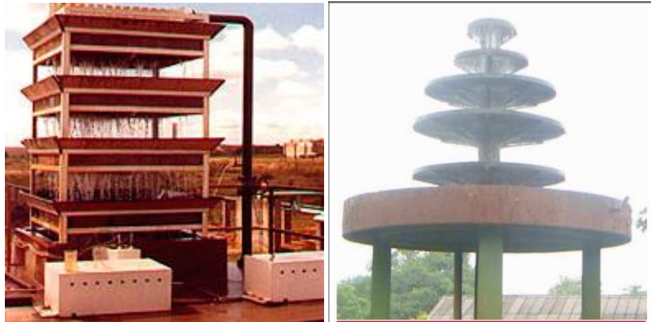
Figura 4 - Aeradores com bandejas e do tipo cascata.
