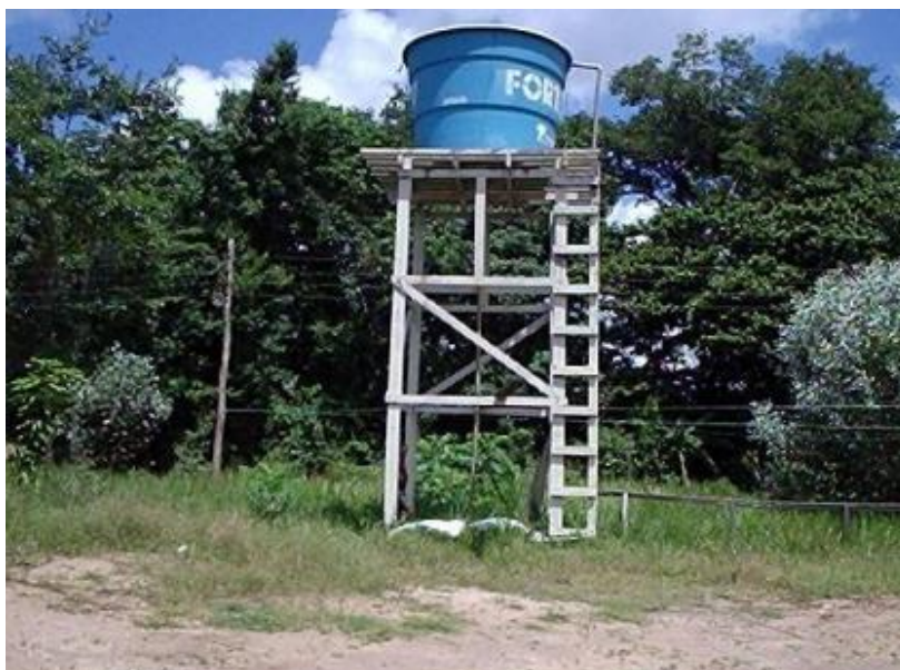
Figura 23 - Sistema de abastecimento em comunidade rural de Oriximiná.
