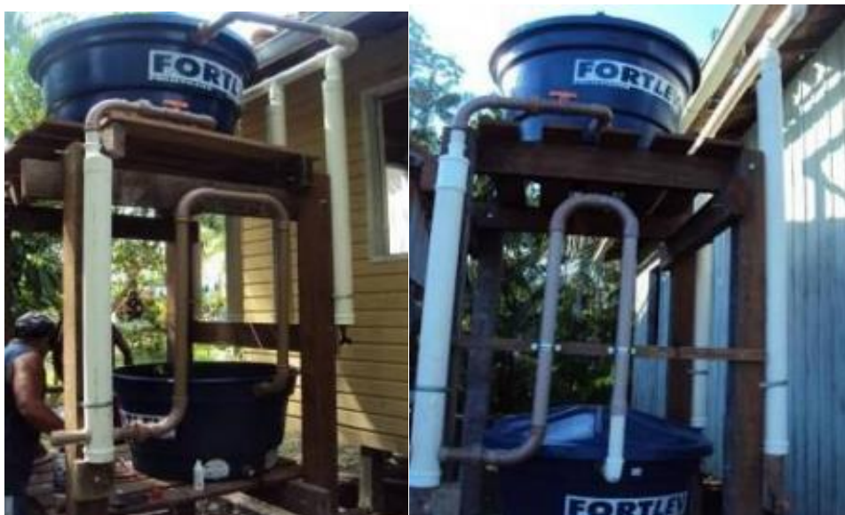
Figura 27 - Sistemas de Aproveitamento da Água de Chuva nas Ilhas Grande e do Murucutu.
