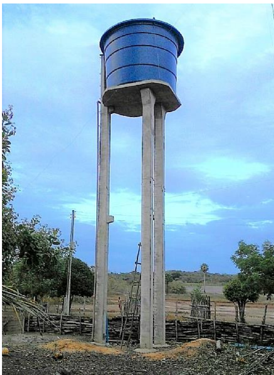
Figura 11 - Reservatório e distribuição implantado na zona rural de Joaquim Pires.
