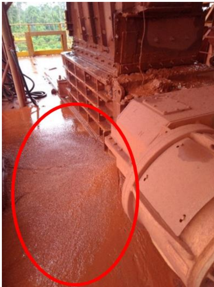
Figura 27. Área de risco de queda do mesmo nível gerada pelo vazamento
