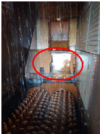
Figura 28. Desgaste interno do Chute de Descarga da 631B-TP-0003
