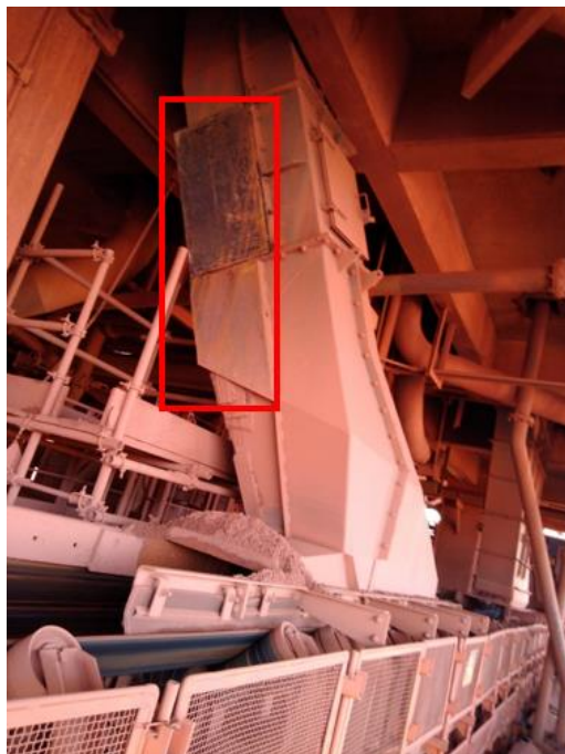
Figura 36. Chute de Descarga do Transportador 631B-TP-0005 – Linha 2
