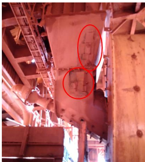
Figura 13. A parte inferior do chute com pequenas chapas soldadas para sanar o vazamento da forma paliativa.
