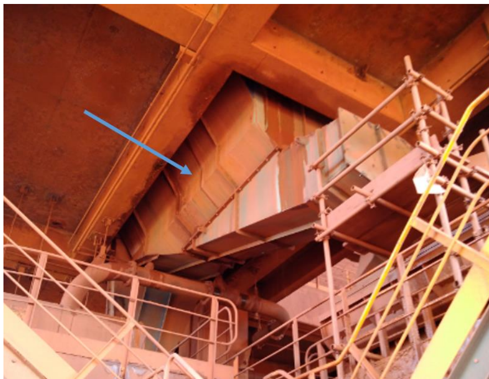
Figura 21. A seta azul indica as zonas molhada causada pelo vazamento no modulo 0004A e 0005A
