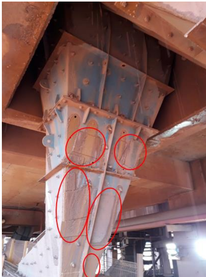
Figura 30. Região de Desgaste dos chutes Over da Peneira 631B-PV-0005
