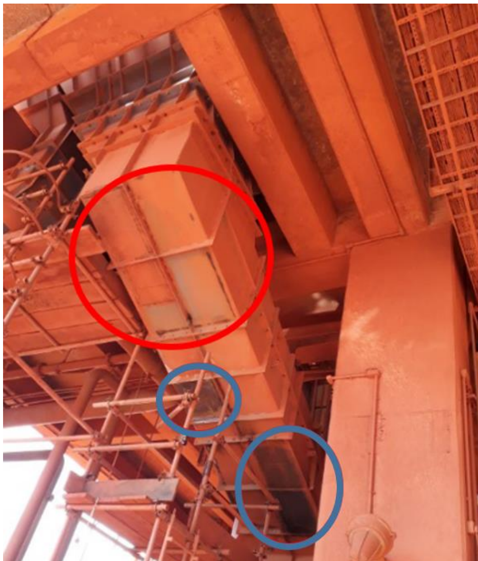
Figura 15. Vazamentos na Zona de Impacto demarcada em vermelho e da Zona de Transição demarcada em azul.
