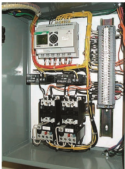
Figura 1 – Painel de controle implementado com o CLP
