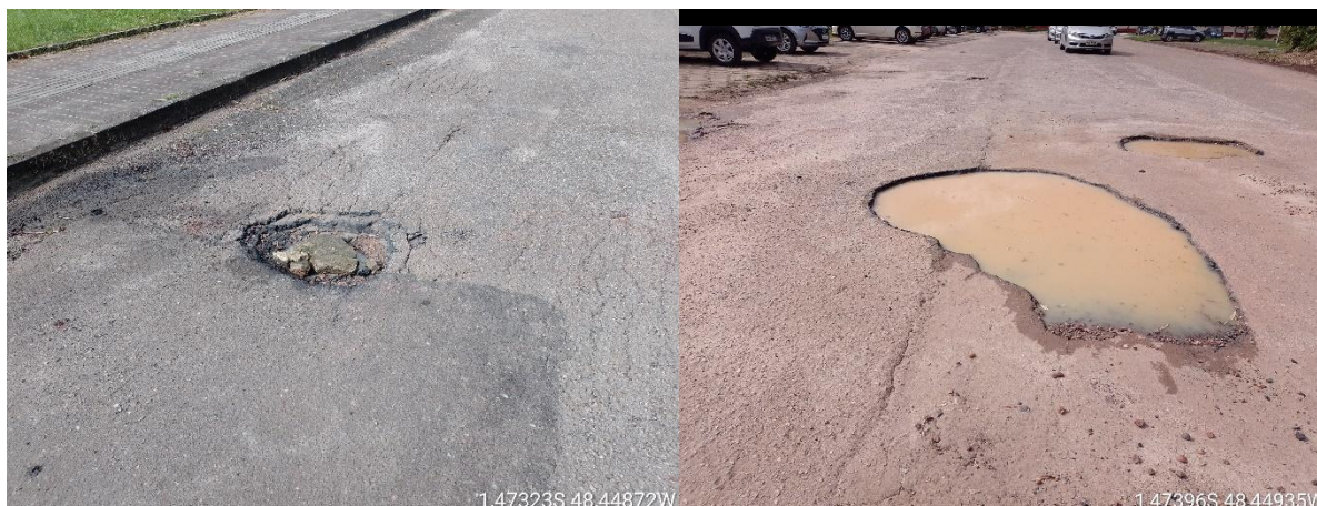
FIGURA 14: defeito panela localizado no trecho 5
