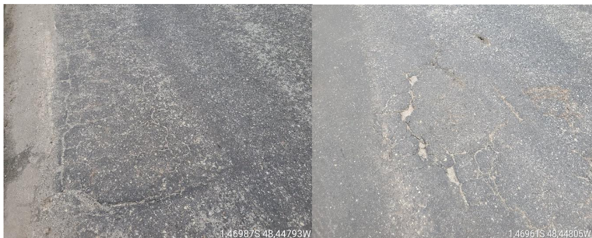
FIGURA 12: defeito trinca por fadiga localizado no trecho 1
