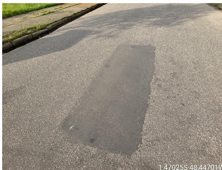
FIGURA 13: defeito remendo localizado no trecho 1
