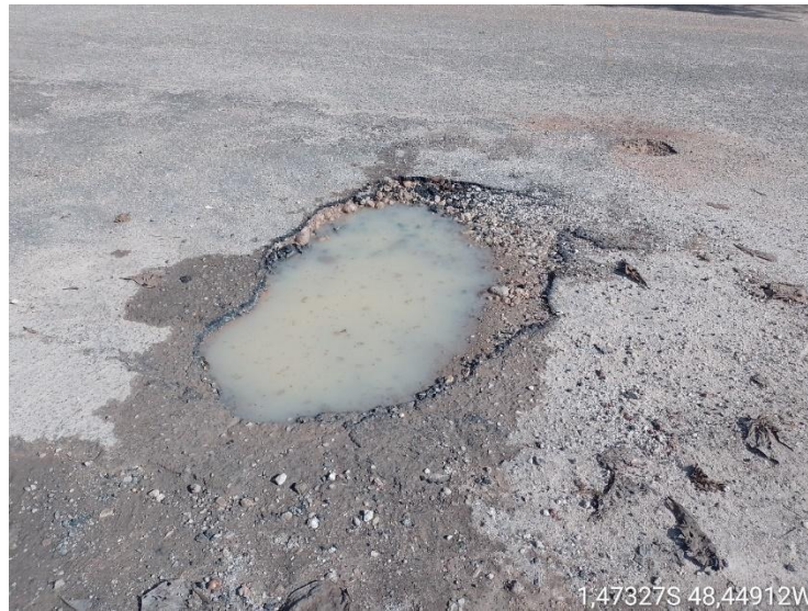
FIGURA 3: Afundamento com defeito do tipo panela
