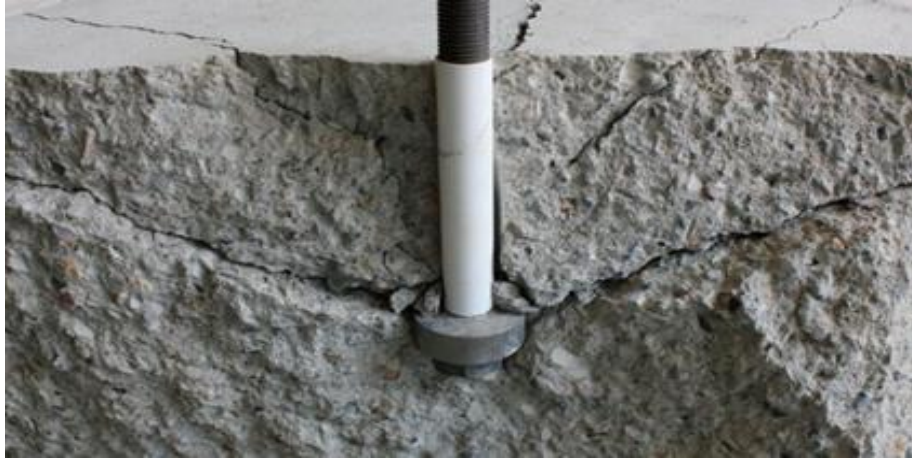
Figura 1 – Seção Transversal da falha do cone de concreto
