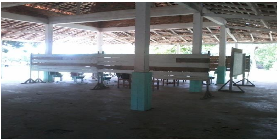
Figura 7 - Divisão das salas improvisadas no barracão da comunidade.
