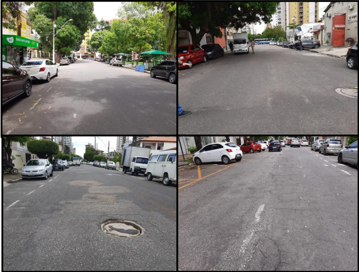
Figura 32 – Trechos com a falta de sinalização adequada (MLS-2)
