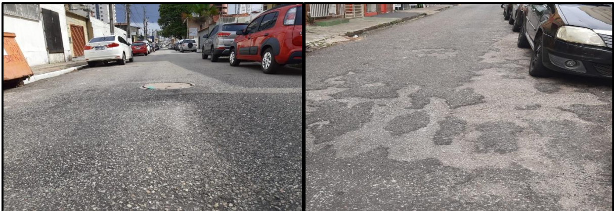
Figura 26 – Desgastes de média e alta severidade
