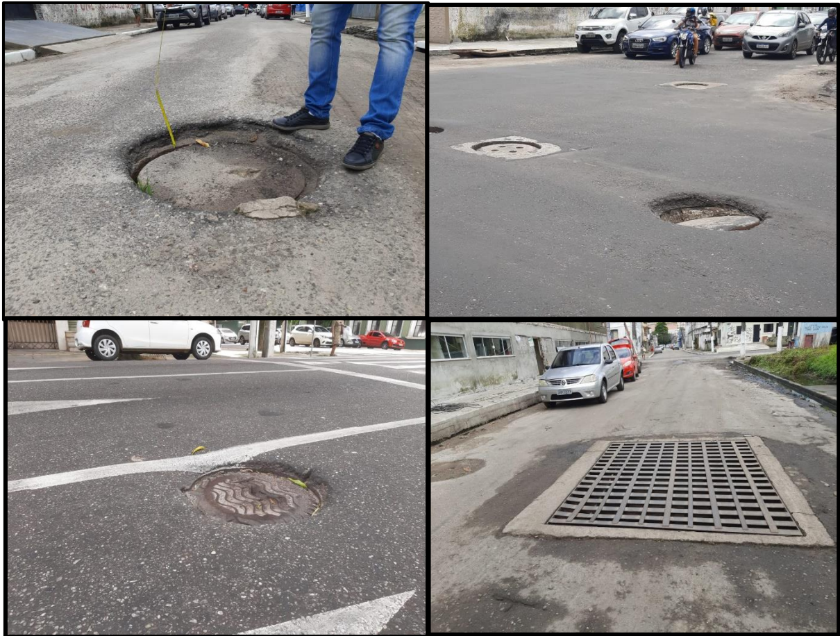
Figura 28 – Interferências com tubulações urbanas
