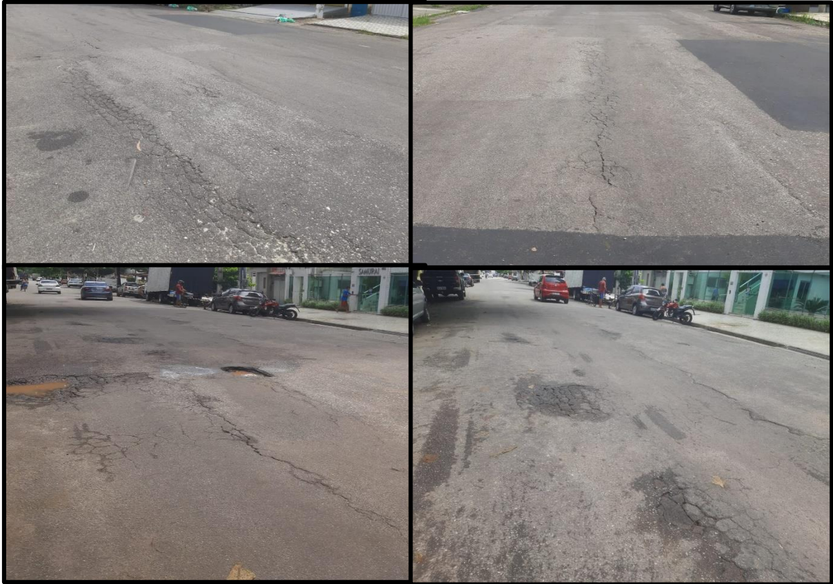
Figura 30 – Defeitos localizados nos trechos críticos do bairro de Batista Campos (C10 e C11)
