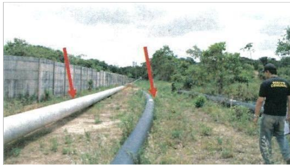
Figura 16 - Mostra a Tubulação em aço inox (esquerda) e em PAD (direita). Fonte: (CPC 2013).
