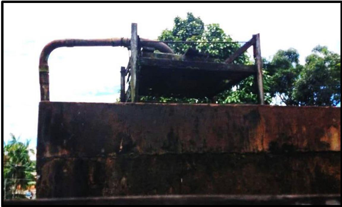
Figura 4 - Aerador tipo tabuleiro.
