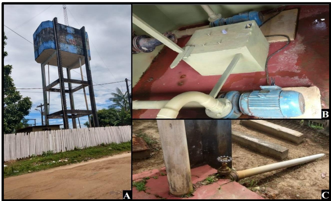
Figura 7 - A : Reservatório de água; B : Bombas para impulsão da água para o reservatório; C : Válvula de saída de água para o consumidor.
