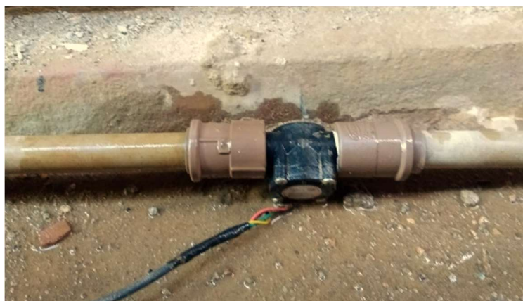
Figura 29 - Medidor instalado no cavalete da residência II
