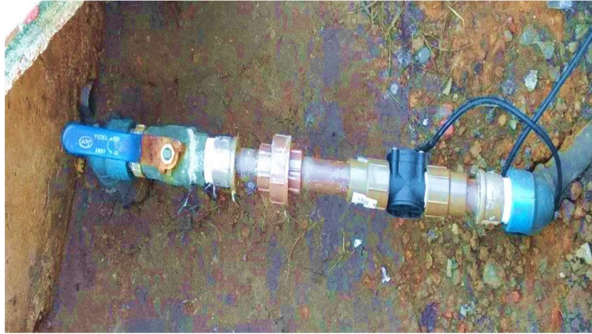
Figura 25 - Medidor instalado no cavalete da residência I
