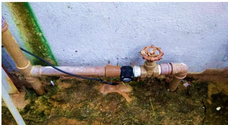
Figura 33 - Medidor instalado no cavalete da residência III
