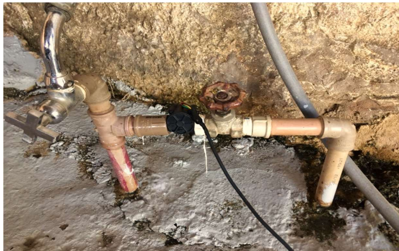
Figura 21 - Sensor de fluxo do protótipo acoplado à tubulação
