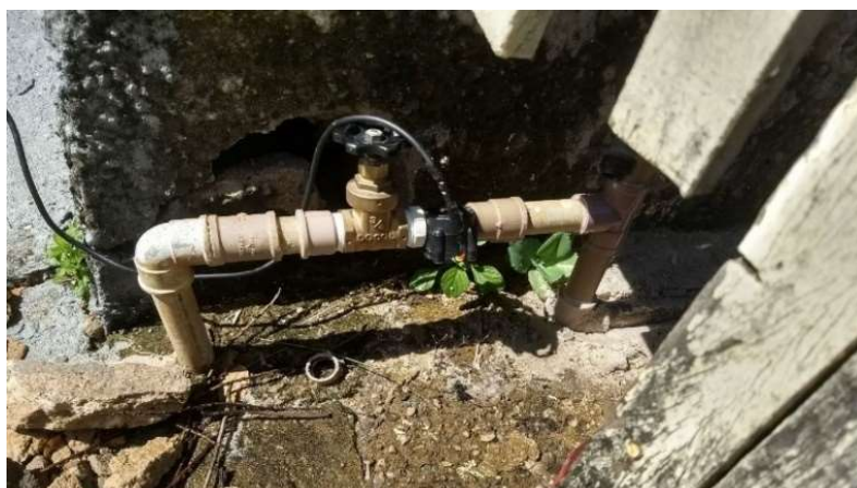
Figura 37 - Medidor instalado no cavalete da residência IV
