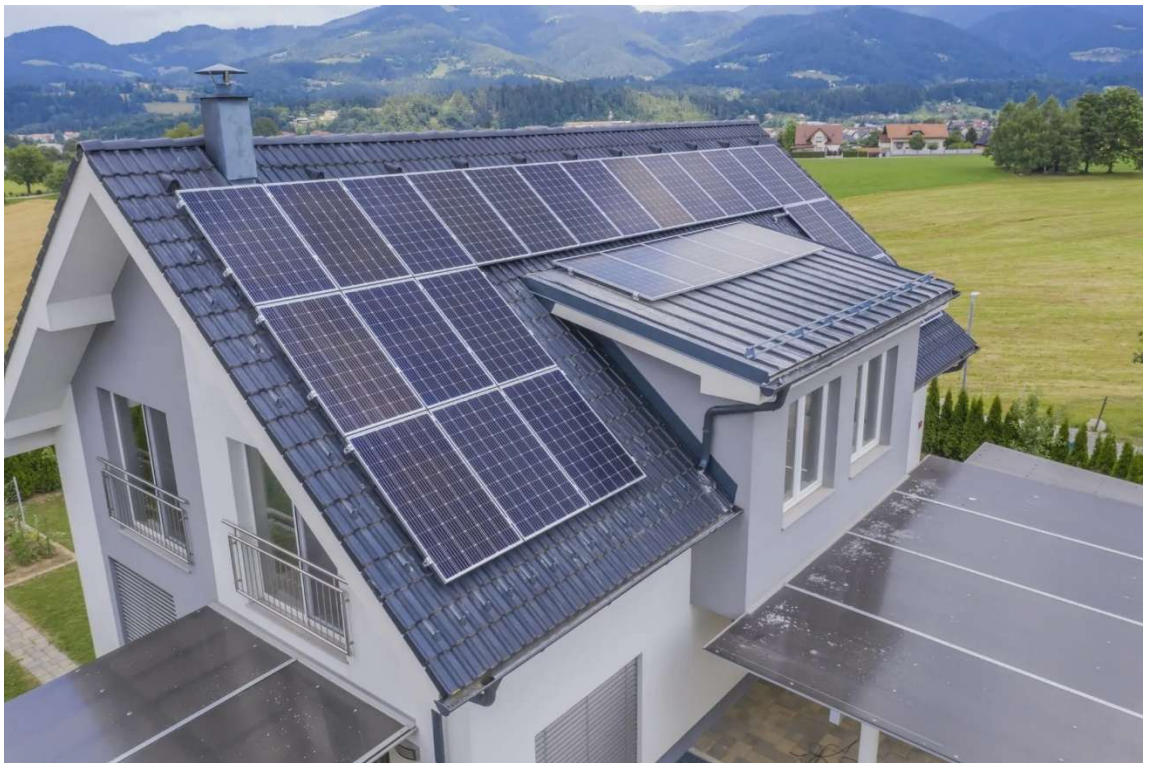
Figura 8 – Sistema de energia solar fotovoltaica instalado em telhado residencial.
