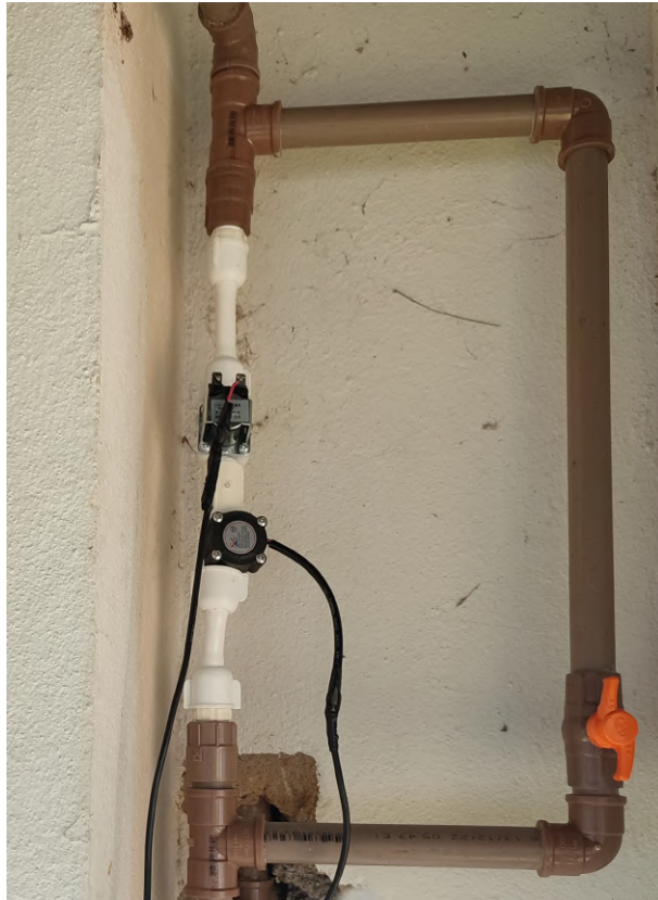
Figura 4.13 – Sensor de fluxo e solenoide instalados no encanamento do banheiro.
