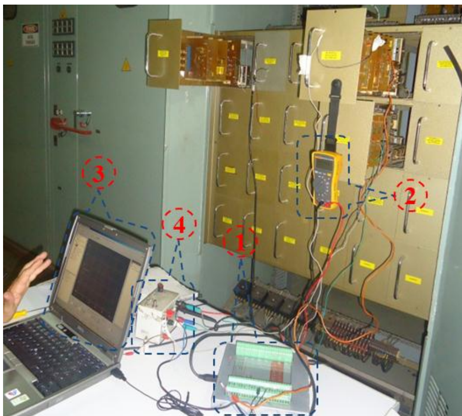
Figura 3.2 – Equipamentos de medição instalados no armário de regulação
