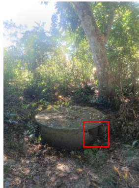
Figura 35. Comprometimento da estrutura externa do aterro familiar 2 do núcleo Porakê – aldeia Trocará
