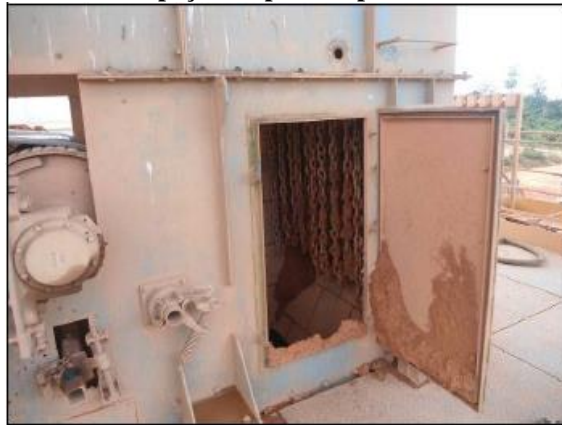
Figura 6 – Porta de inspeção na parte superior de um chute (capota).
