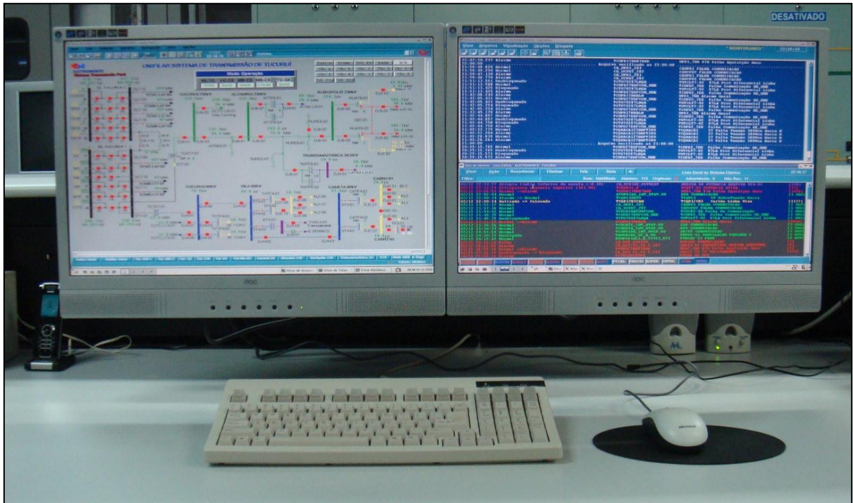
Figura 4.8 - Estação de Operação com o Sistema Aberto de Gerenciamento de Energia.
