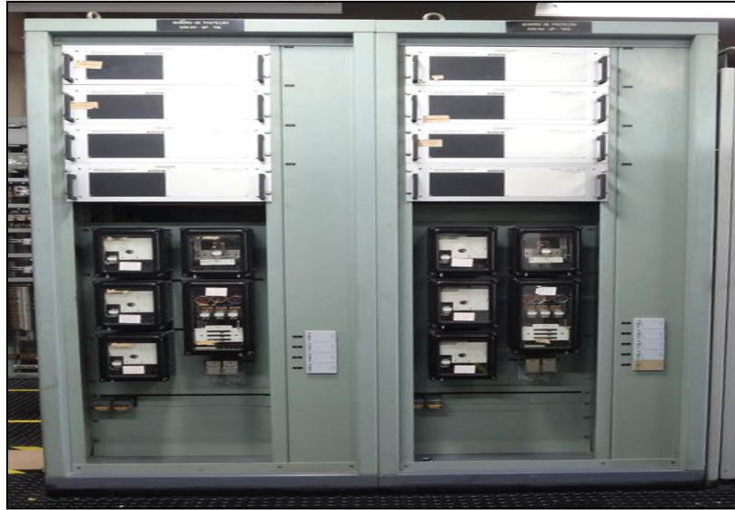
Figura 4.4 – Quadro de proteção com relés convencionas.
