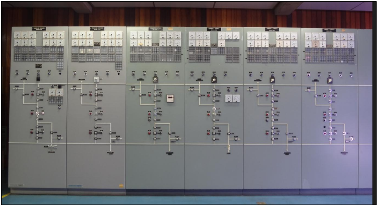
Figura 4.2 – Quadro de Comando e Controle.
