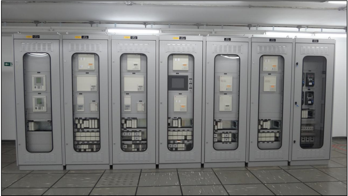
Figura 4.5 – Painéis de proteção e controle digitais.
