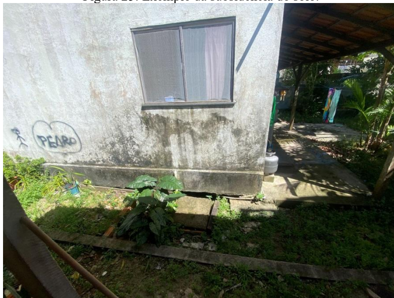
Figura 25: Exemplo da subsidência do solo.
