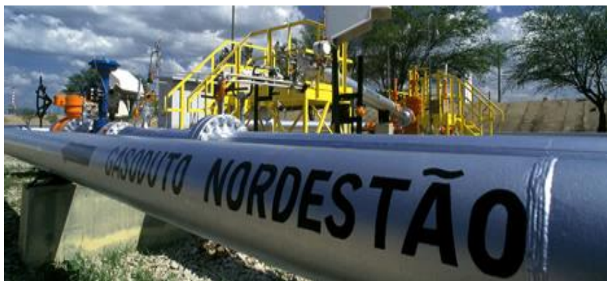
Figura 2 – Gasoduto Nordesteão percorre 424 km entre Guamaré (RN) e Cabo (PE).
