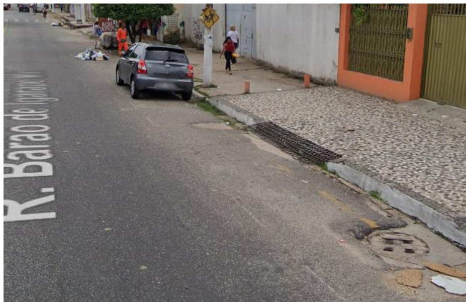
Figura 17: Lixo e Bueiro na faixa de estacionamento – R. Barão de Igarapé Miri
