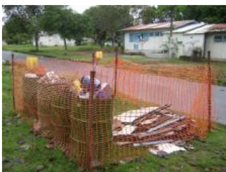
Figura 58 – Segregação e isolamento de entulhos
