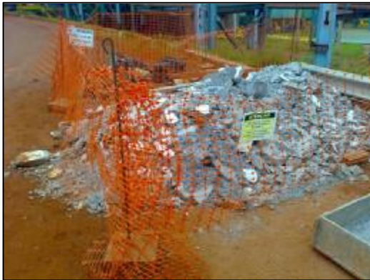
Figura 6 – Transtorno gerado pelo resíduo de construção civil
