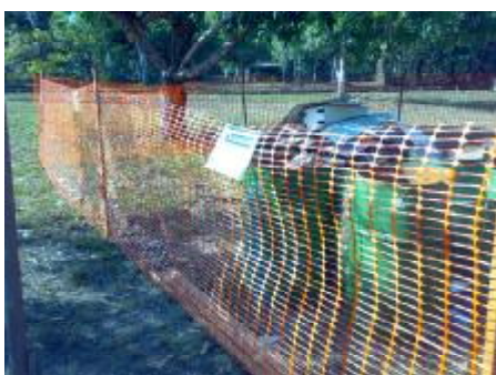
Figura 56 – Segregação e isolamento de entulhos Fonte: Durante visita as obras de Porto Trombetas
