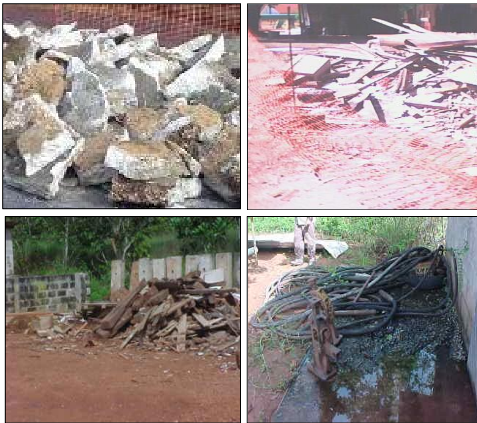
Figura 2 – Disposição inadequada de resíduos
