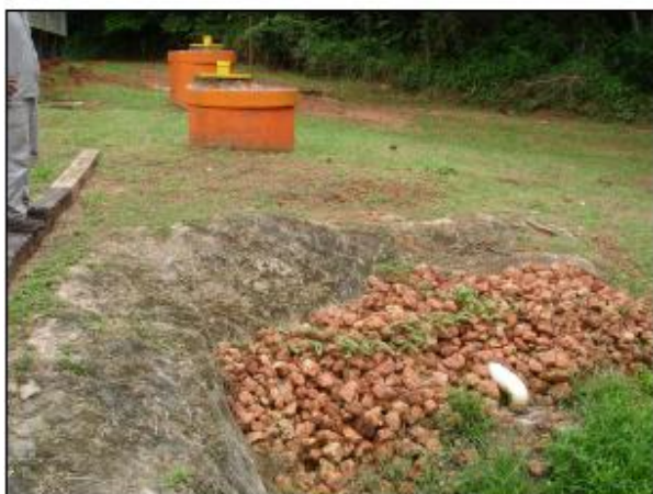
Figura 63 Tratamento de chorume da UTC
