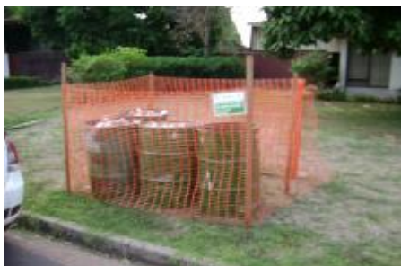
Figura 55 – Segregação e isolamento de entulhos Fonte: Durante visita as obras de Porto Trombetas
