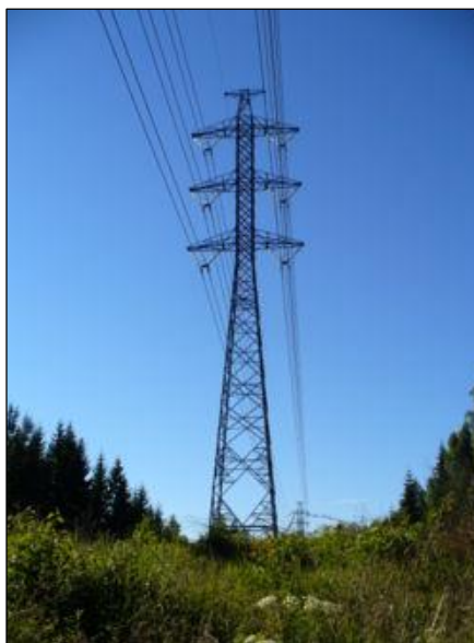
Figura 1 - Suporte de linhas de transmissão de energia.
