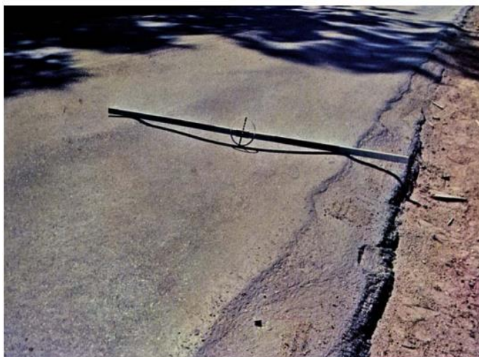
Figura 2 - Afundamento em Trilha de Roda na Pavimentação Asfáltica
