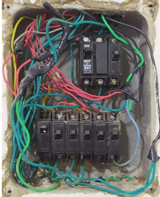
Figura 6 – Quadro de distribuição dos circuitos
