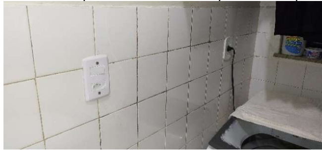
Figura 1 – Tomadas que alimentam ferro de passar e máquina de lavar
