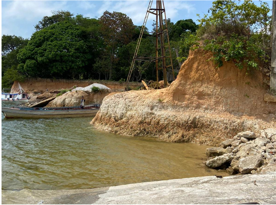
Figura 9 – Feição 4 com talude comprometido
