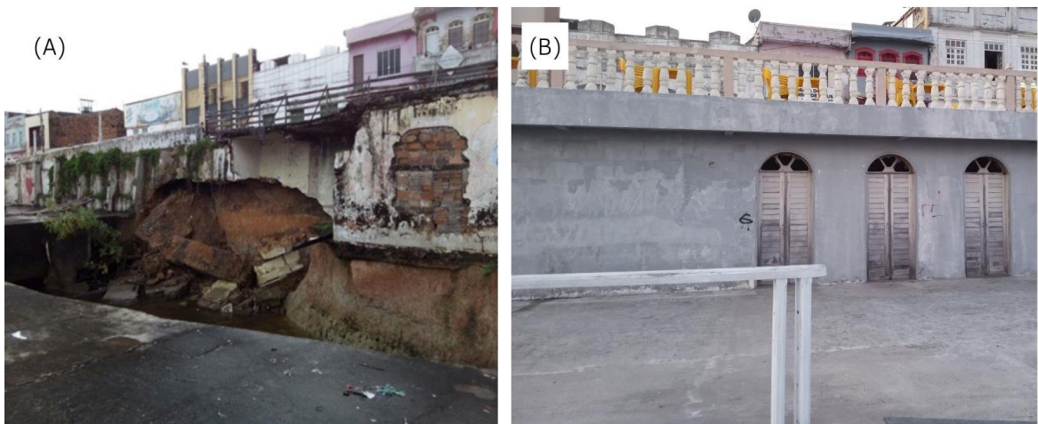
Figura 7 – A) Trapiche destruído por conta da erosão; B) Trapiche reconstruído
