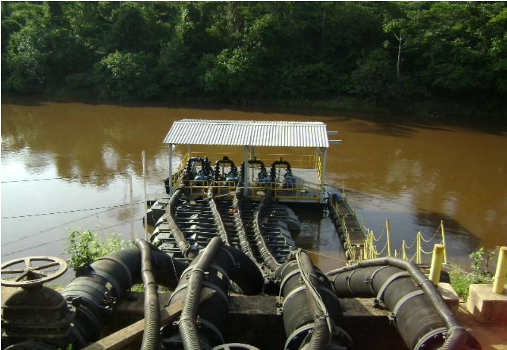
Figura 03: Unidade de captação de Sistema de Abastecimento de Água da cidade de Parauapebas-Pa.
