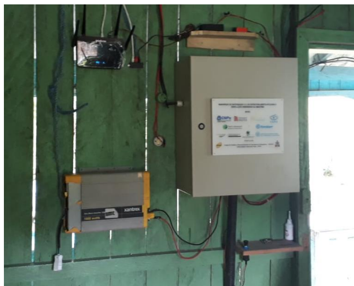
Figura 2.8 - Quadro de distribuição do Sistema 03.
