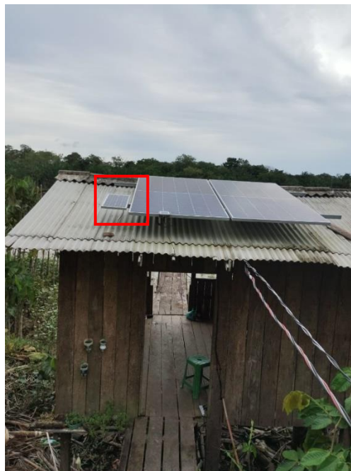
Figura 3.5 – Módulo fotovoltaico de referência (sensor) instalado no Gerador do sistema 06 (destaque em vermelho).
