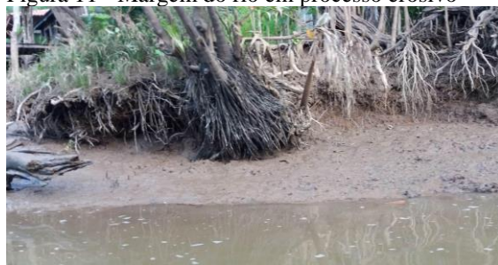
Figura 11 - Margem do rio em processo erosivo
