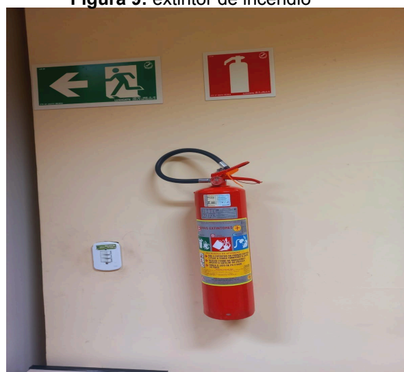
Figura 9: extintor de incêndio
