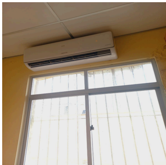
Figura 7: Ar condicionado/ janela sem bloqueio
