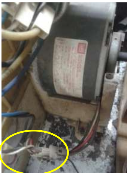
Figura 6. Motoventilador instalado, com destaque para os terminais de ligação.
