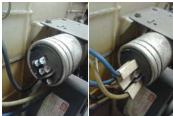
Figura 8. Capacitor instalado no condicionador de ar. Detalhe para a conexão dos bornes.
