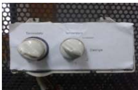
Figura 11. Caixa de comando do condicionador de ar.
