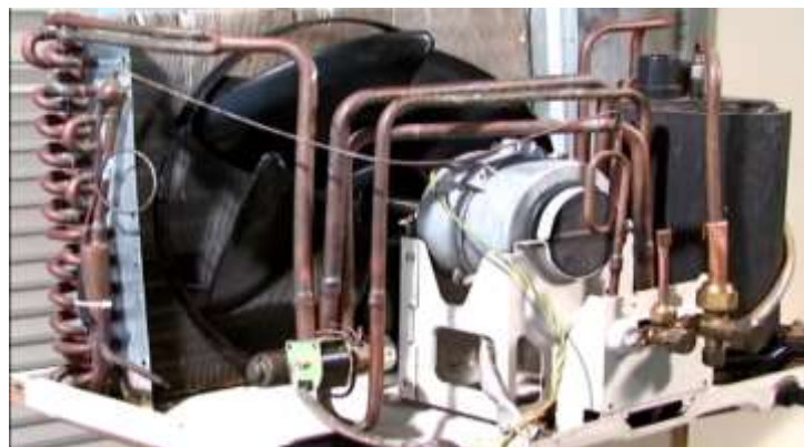
Figura 3. Detalhe da parte interna da unidade de condensação, onde é possível observar vários elementos presentes em um condicionador de ar tipo janela.
