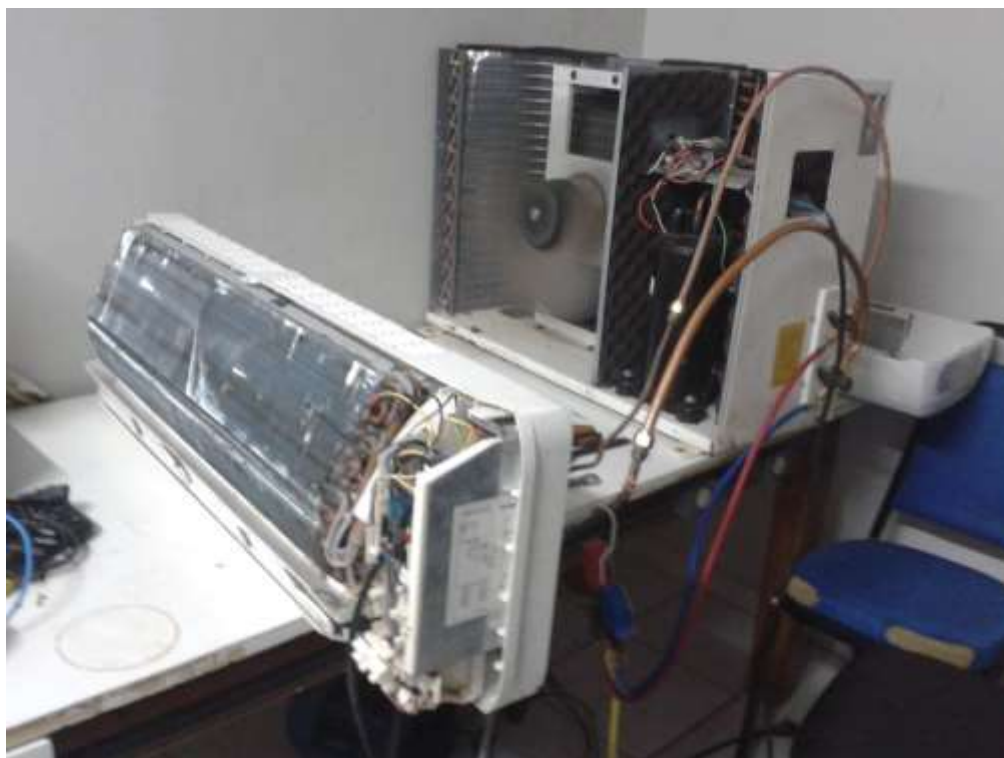
Figura 8. Equipamento funcionando perfeitamente, pronto para a utilização nas aulas práticas.
