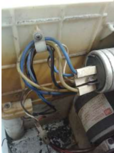
Figura 2. Condutores do circuito elétrico de um condicionador de ar.
