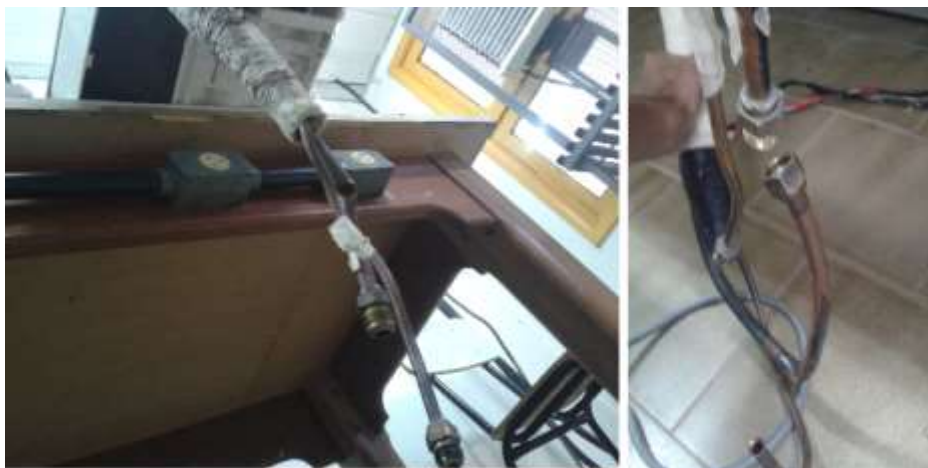
Figura 1. Tubos de gás da unidade evaporadora.
