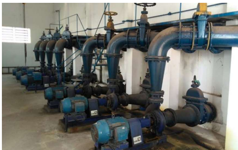
Figura 25 - Conjunto motor bomba do 1º setor e do 2º setor.
