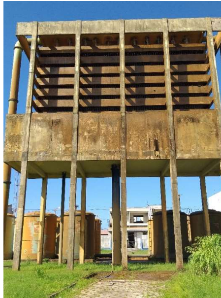
Figura 24 - Aerador tipo tabuleiro
