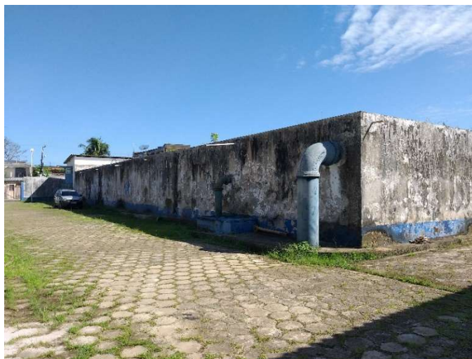
Figura 26 - Reservatório Apoiado e tanque de contato.
