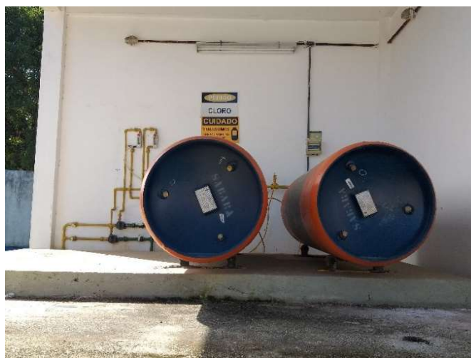
Figura 23 - Reservatório de cloro gasoso
