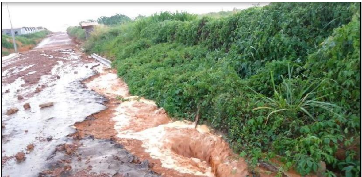
Figura 23 - Escoamento resultando em danos ao pavimento.
