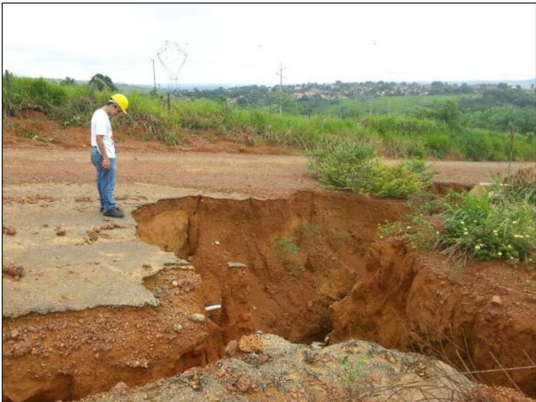
Figura 30 - Cratera localizada em cruzamento de ruas.
