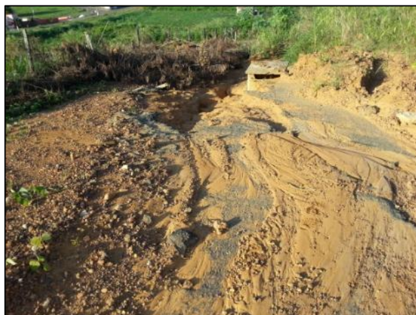
Figura 31 - Sedimentos carregados pelas águas pluviais.
