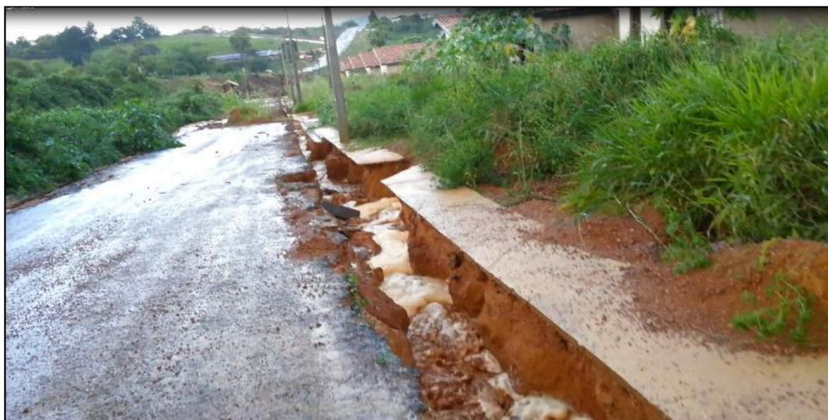
Figura 26 - Sarjetas totalmente destruídas.
