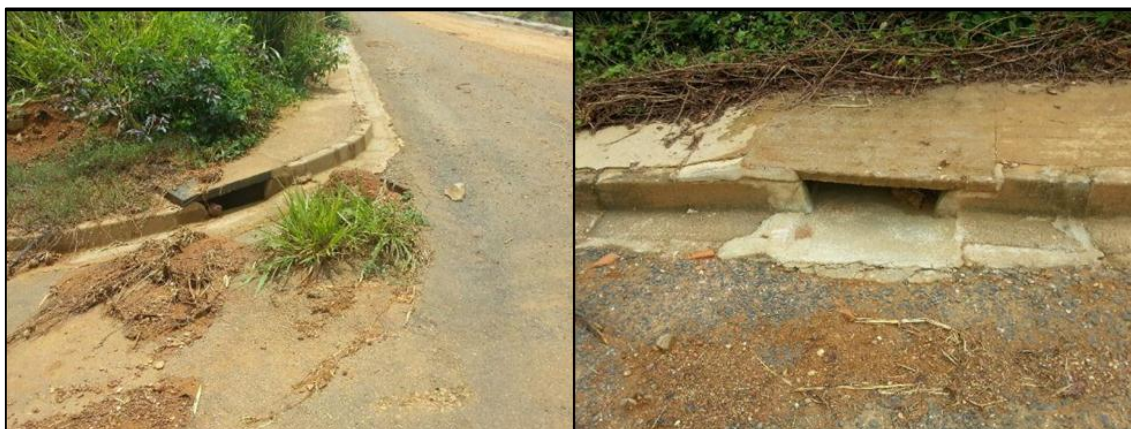
Figura 43 - Boca de lobo tipo simples no residencial.
