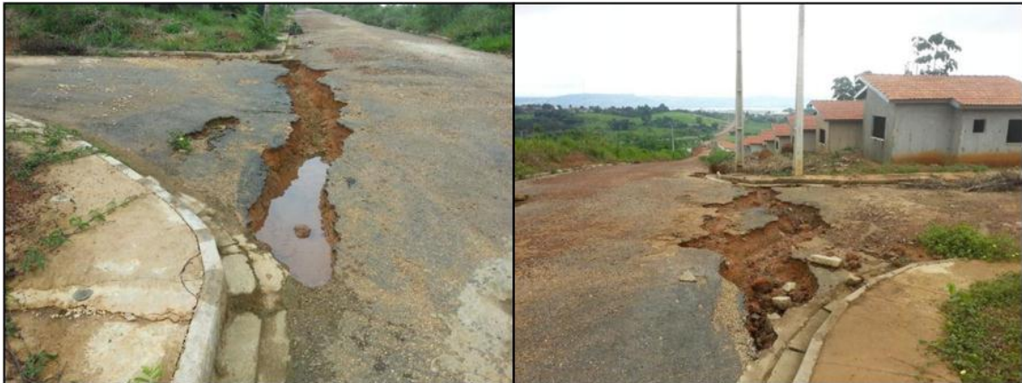
Figura 29 - Aberturas no pavimento em cruzamentos de ruas.
