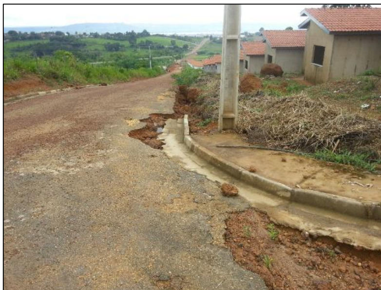
Figura 27 - Processo erosivo no leito das ruas.
