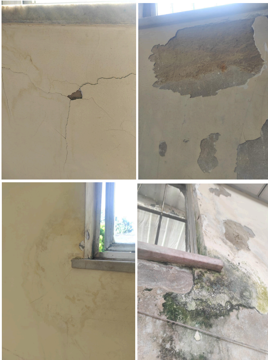
Figura 11 — Infiltrações no interior do prédio no térreo, próximas a janelas
