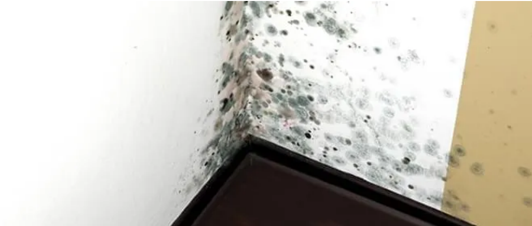
Figura 4 — Bolor em parede
