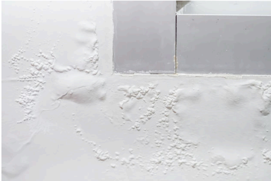
Figura 2 — Bolhas na pintura
