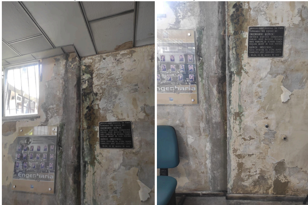
Figura 10 — Infiltração no interior do prédio no térreo
