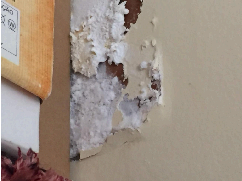
Figura 3 — Eflorescência em revestimento
