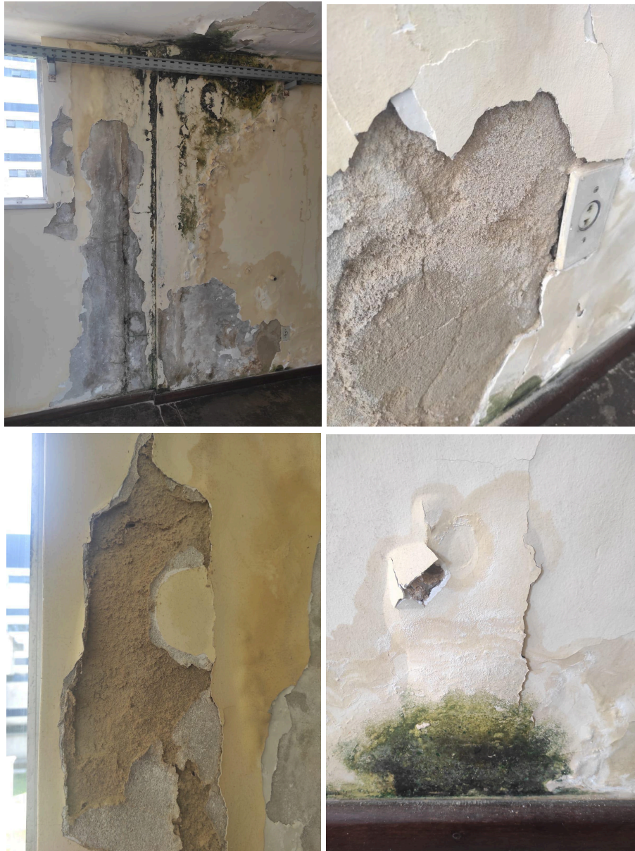
Figura 13 — Infiltrações no interior do prédio no 1º pavimento
