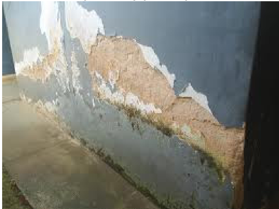
Figura 5 — Desagregamento em parede
