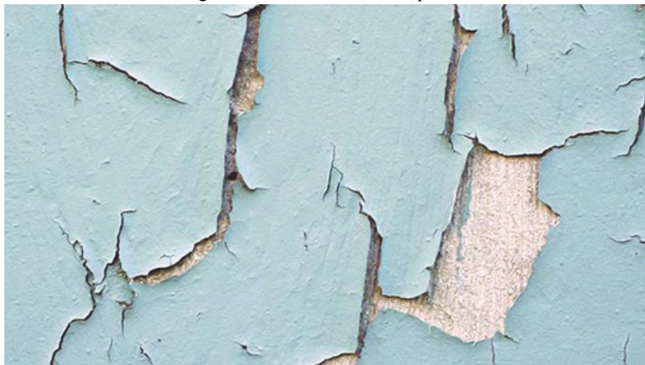
Figura 5 — Descascamento de pintura
