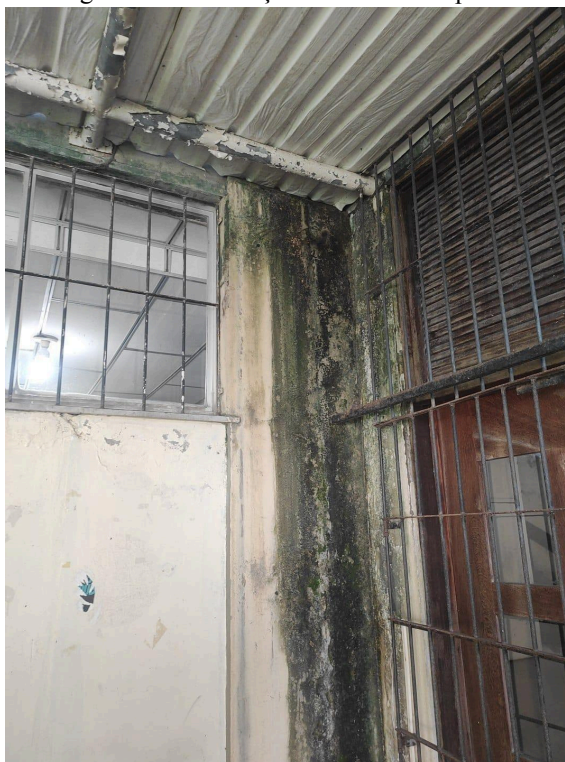
Figura 9 — Infiltração na entrada do prédio
