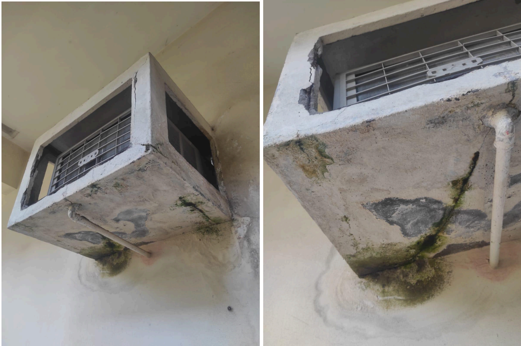
Figura 12 — Infiltrações no interior do prédio no térreo, no abrigo de ar-condicionado
