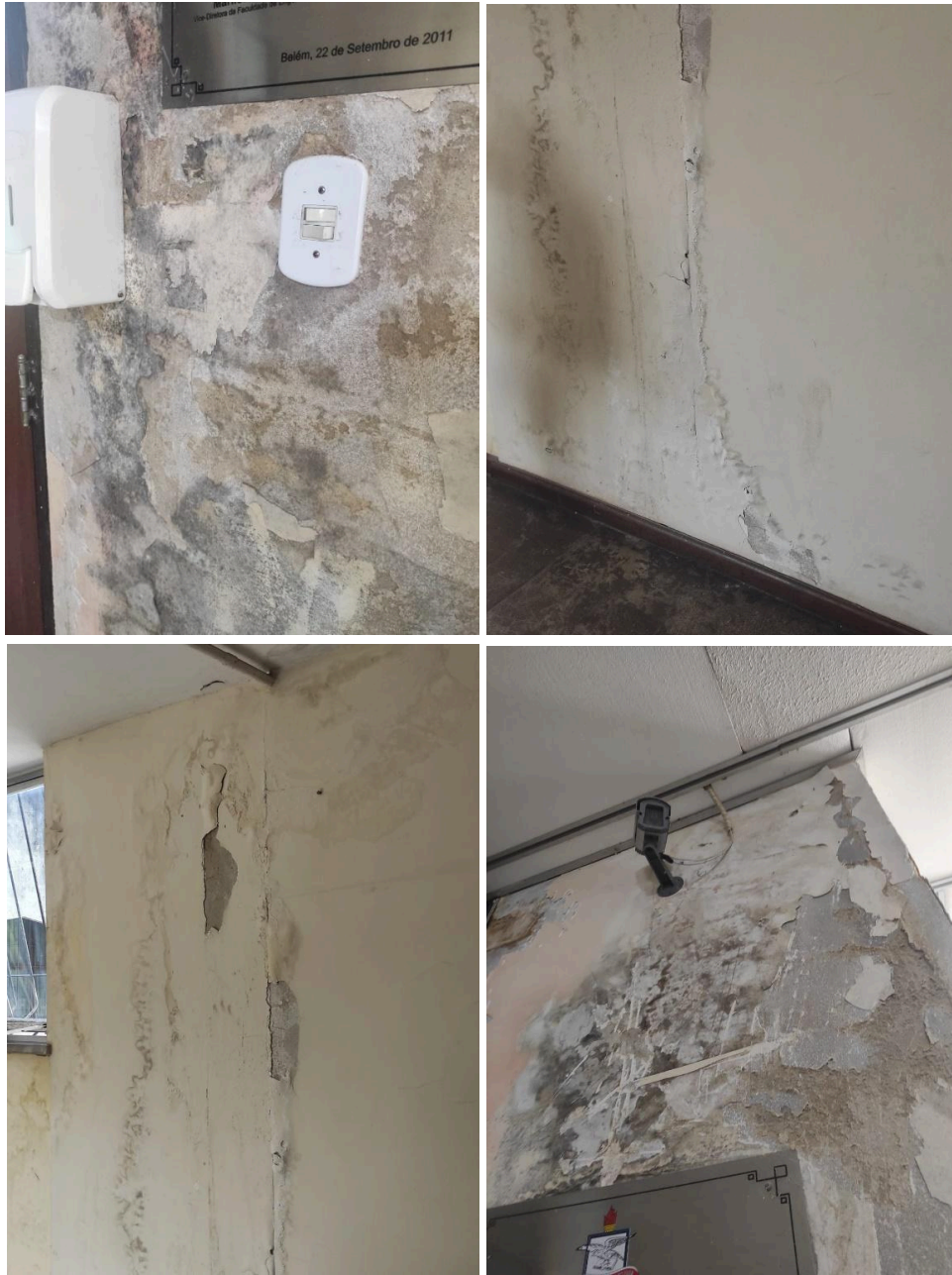
Figura 15 — Infiltrações no interior do prédio, no 1º pavimento
