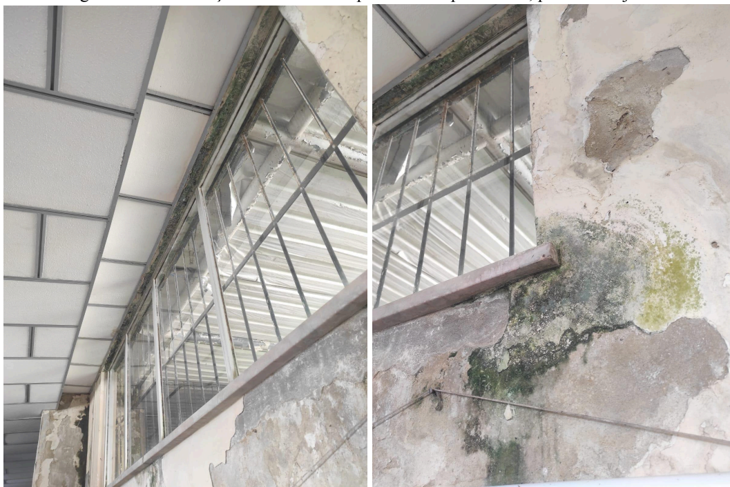
Figura 16 — Infiltrações no interior do prédio no 1º pavimento, próximas a janelas
