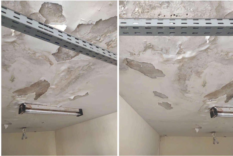
Figura 14 — Infiltrações no interior do prédio, no forro, no 1º pavimento
