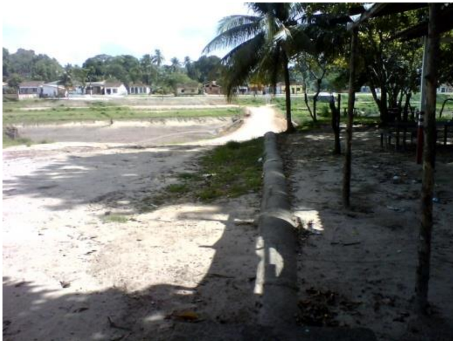
FIGURA 12 - TUBULAÇÃO EXPOSTA NA RUA DO ROSÁRIO CONTENDO ÁGUA DE ESGOTO E PLUVIAL SENDO DESPEJADO NO MANGUE
