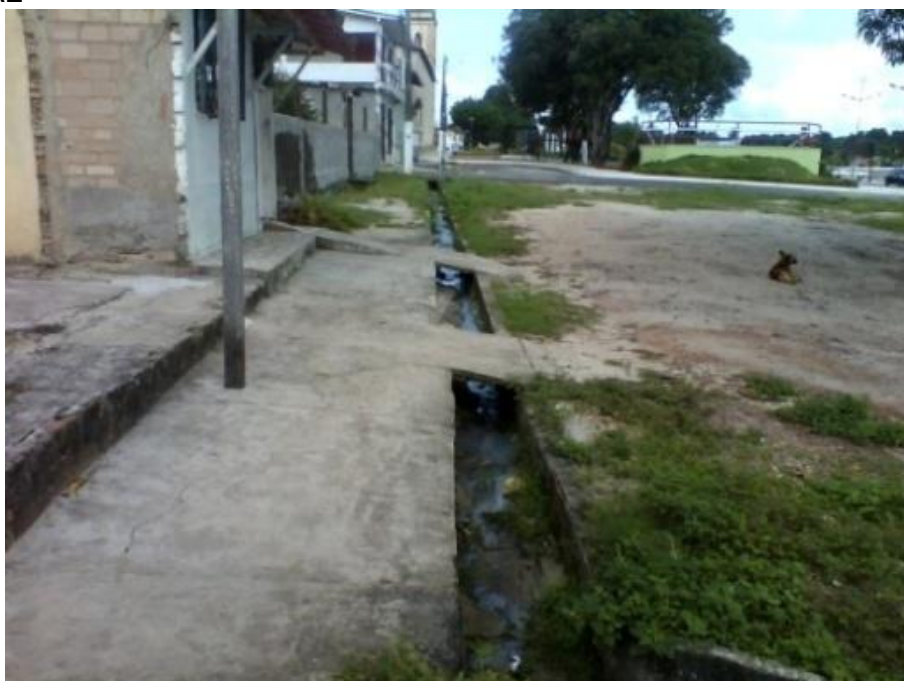
FIGURA 09 - VALA NA RUA DO ROSÁRIO CONTENDO ESGOTO E ÁGUA PLUVIAL
