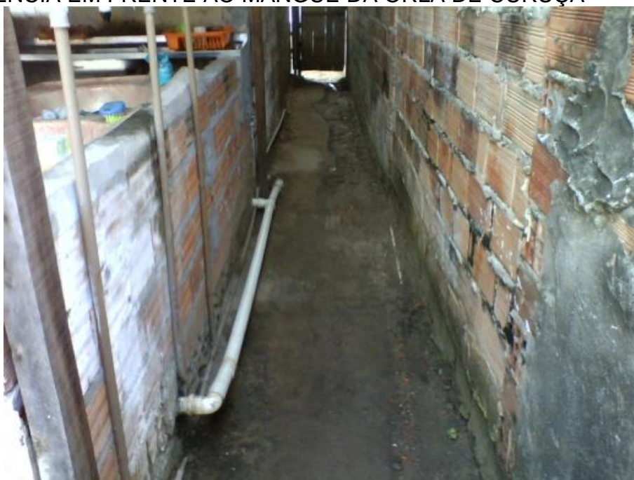
FIGURA 07- VISTA DE TUBOS DE ESGOTO EM CORREDOR DE RESIDÊNCIA EM FRENTE AO MANGUE DA ORLA DE CURUÇÁ
