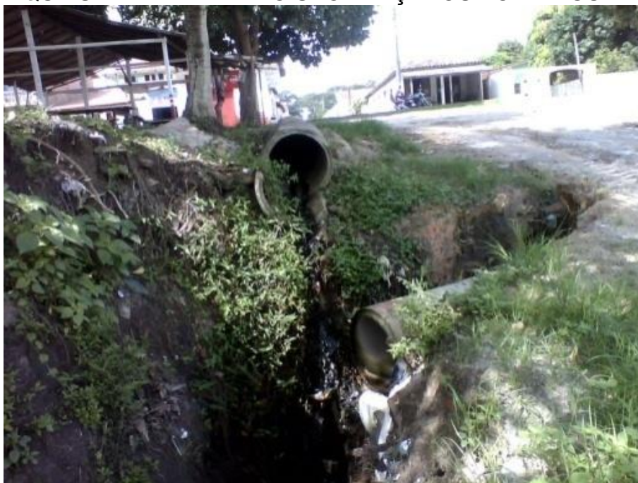
FIGURA 14 - VÁRIAS TUBULAÇÕES CONTENDO ESGOTO E ÁGUA PLUVIAL QUE SEM TRATAMENTO SÃO LANÇADOS AO MANGUE
