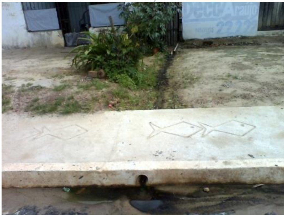
FIGURA 16 - TUBULAÇÃO DE ESGOTO SANITÁRIO INADEQUADA EM RESIDÊNCIA NA RUA DO BARRO ALTO, EM FRENTE AO MANGUE
