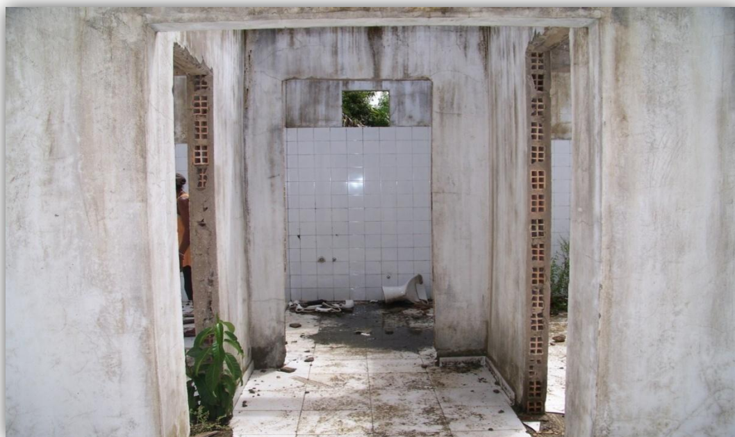
Figura 19- Banheiros do centro de triagem de Soure (PA) evidenciando a destruição ocorrida-2010
