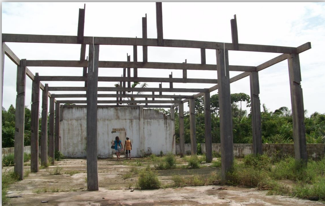
Figura 20- Centro de Triagem destruído na cidade de Soure (PA)-2010
